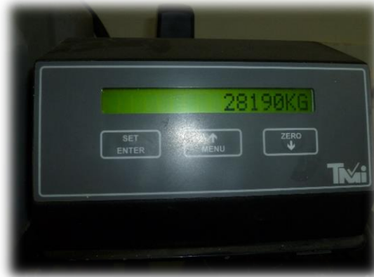
Foto N° 05. Tablero de control
