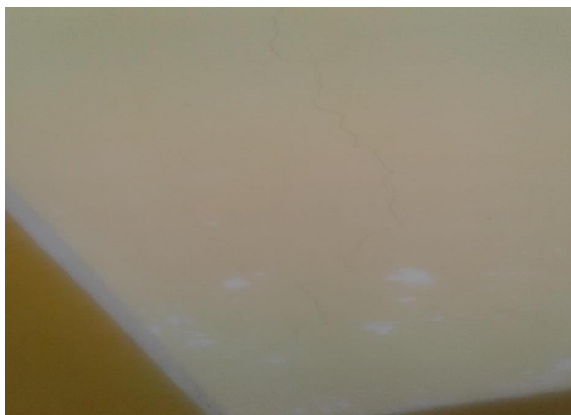
Figura 10: el fisuramiento está presente en la losa aligerada
