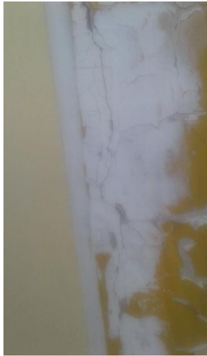
Foto 7: fisuras en columna y descascaramiento
