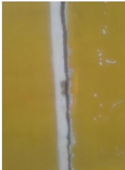
Foto 6: En esta foto vemos q hay rajadura q se está apartando la pared
