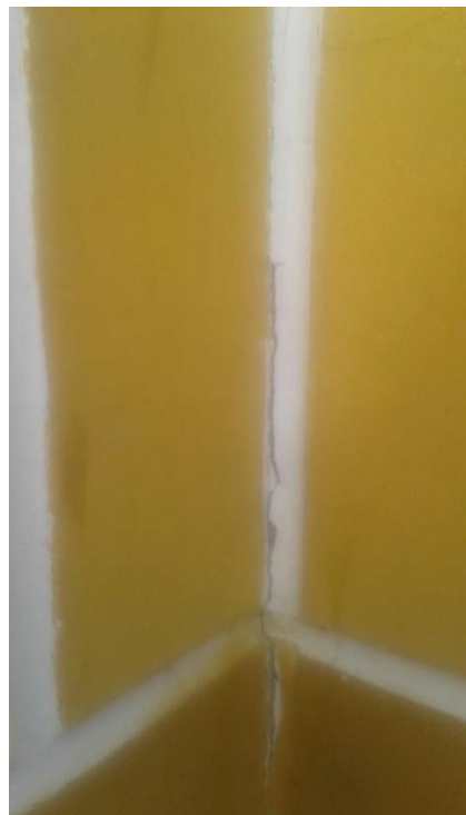
Foto 8: fisuramiento muro – columna
