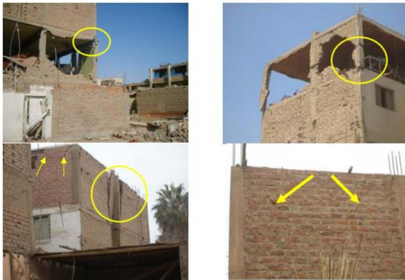
Figura 10 Viviendas autoconstruidas Terremoto Pisco 2007
