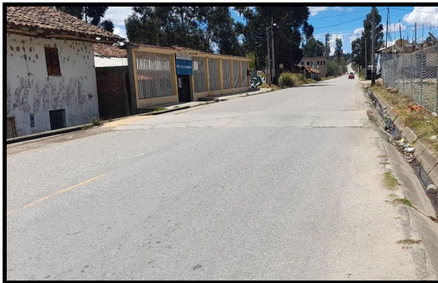
Imagen 04: Tramo de carretera sin señalización horizontal
