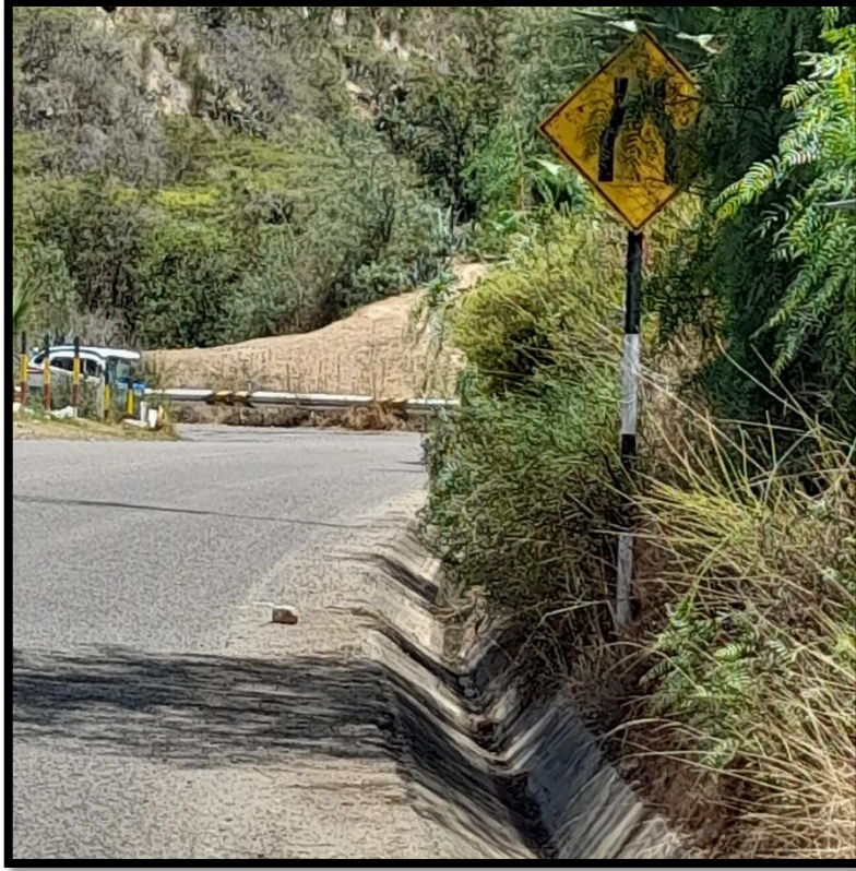
Imagen 11: Señal preventiva no visible por arbustos
