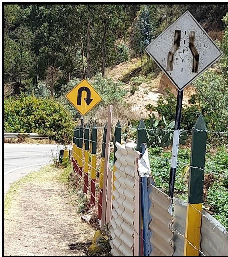
Imagen 09: Señales preventivas en estado regular.
