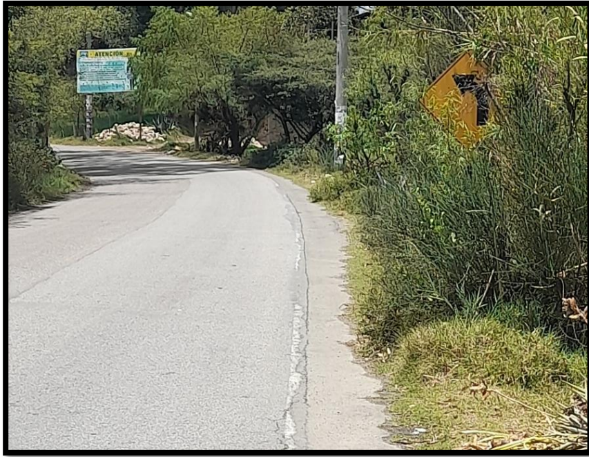
Imagen 13: Señal preventiva no visible por arbustos
