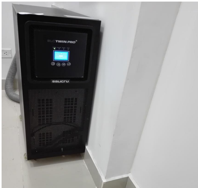
Figura 18:SERVIDOR CAC CHIMBOTE
