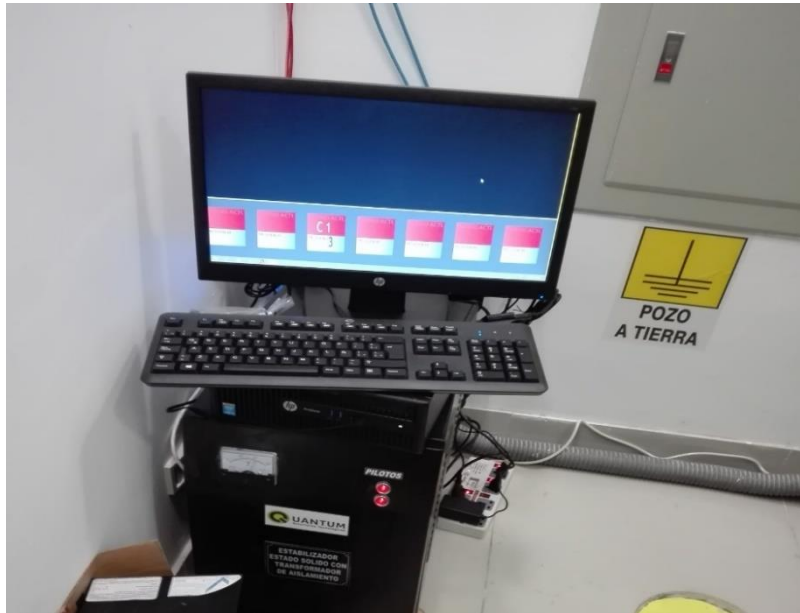
Figura 19:SERVIDOR CAC CHIMBOTE
