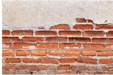
Figura 2. Erosión en muros de mampostería.
