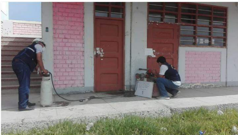
Figura 80: Bombeo para ejercer energía en el equipo M-1
