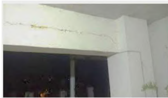
Figura 1. Grieta en viga de concreto armado.
