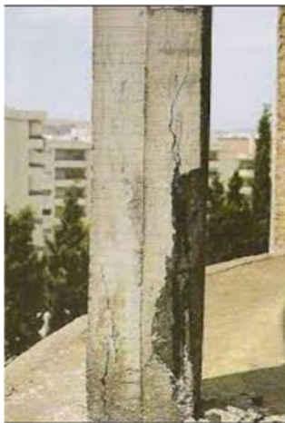
Figura 4. Desprendimiento del concreto en columnas.
