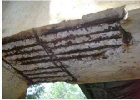
Figura 5. Corrosión del acero en una viga.
