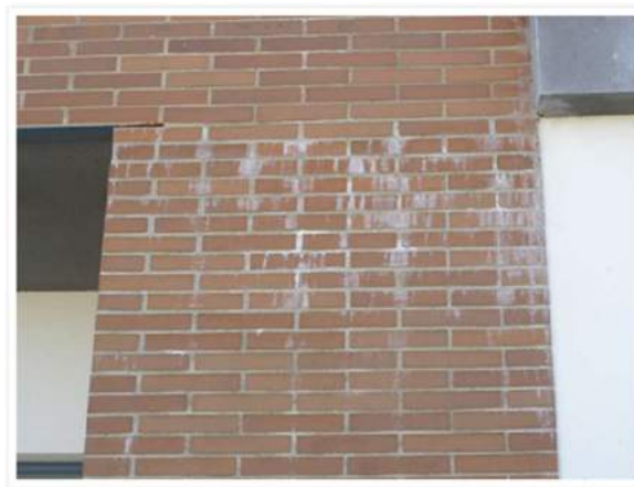
Figura 6. Eflorescencia en muro de mampostería.
