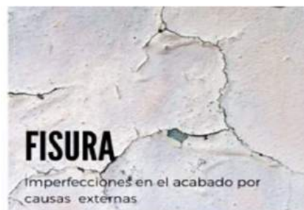
Figura 3. Fisura en muro.
