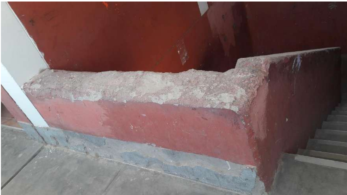
Figura N° 4 Estructura deteriorada debido a la antigüedad del colegio Fuente: Elaboración Propia
