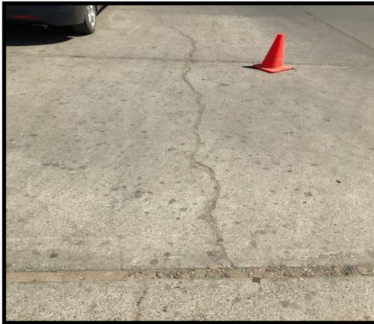
Figura 10: vista de las fisuras del pavimento.
