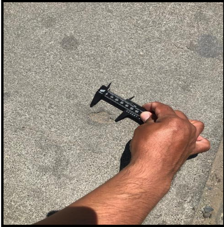
Figura 18: vista y medición de vacíos del pavimento.
