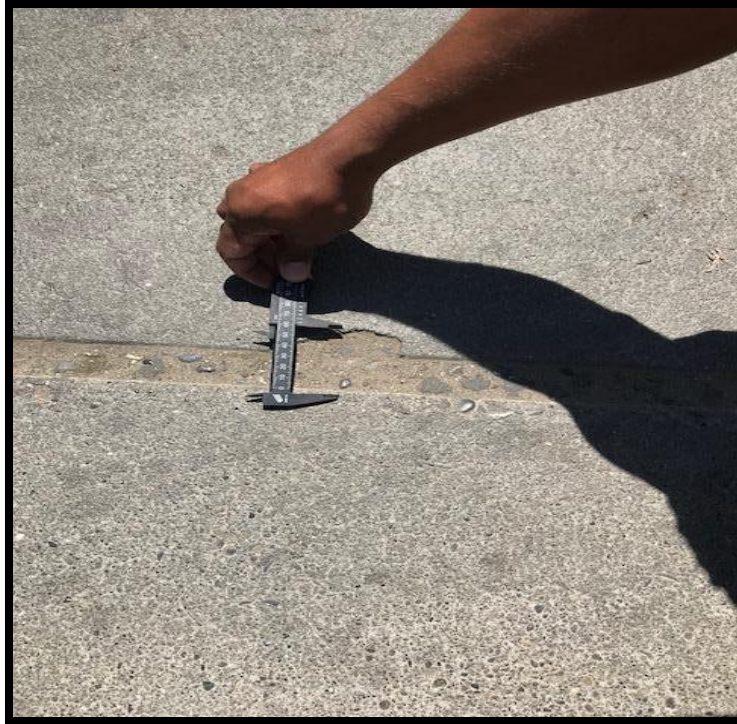
Figura 14: midiendo la junta de dilatación con vernier.
