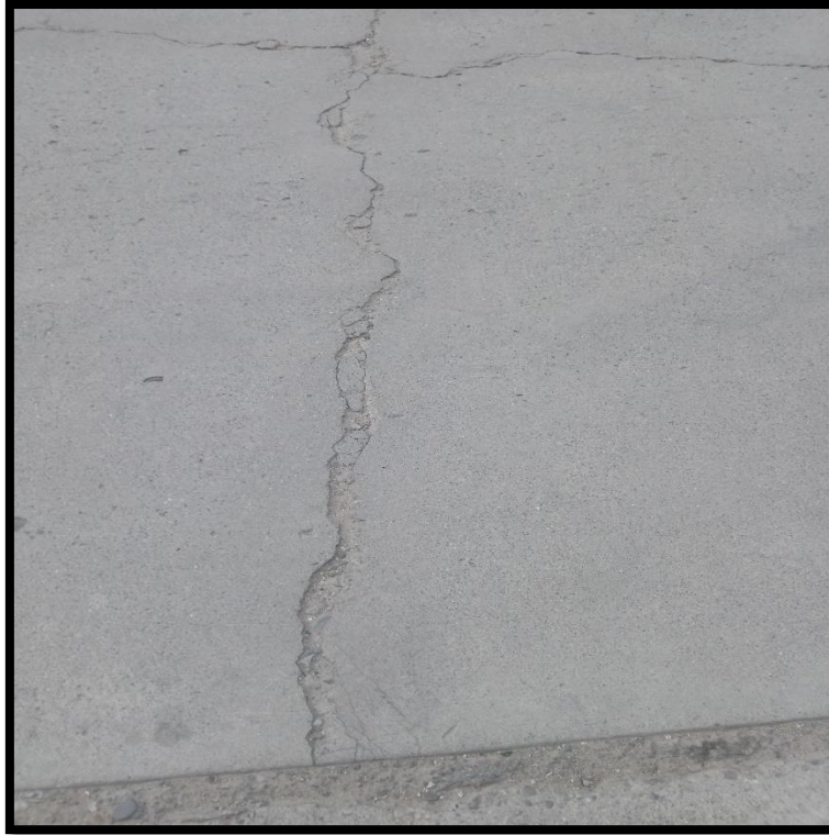
Figura 12: vista de fisura en la cuadra 2.
