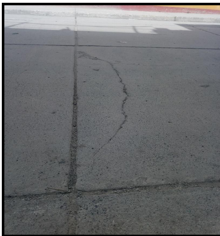
Figura 16: vista de fisuras en la cuadra-3
