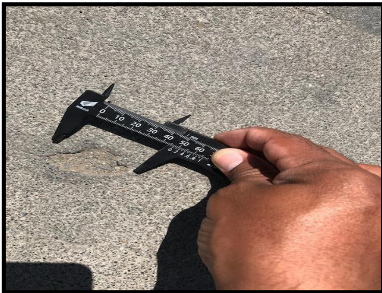
Figura 19: vista y medición de vacíos del pavimento.
