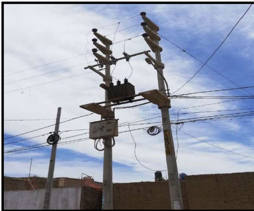
Figura 2. Punto de alimentación referencial indicado por HIDRANDINDA S.A., subestación PA6018
