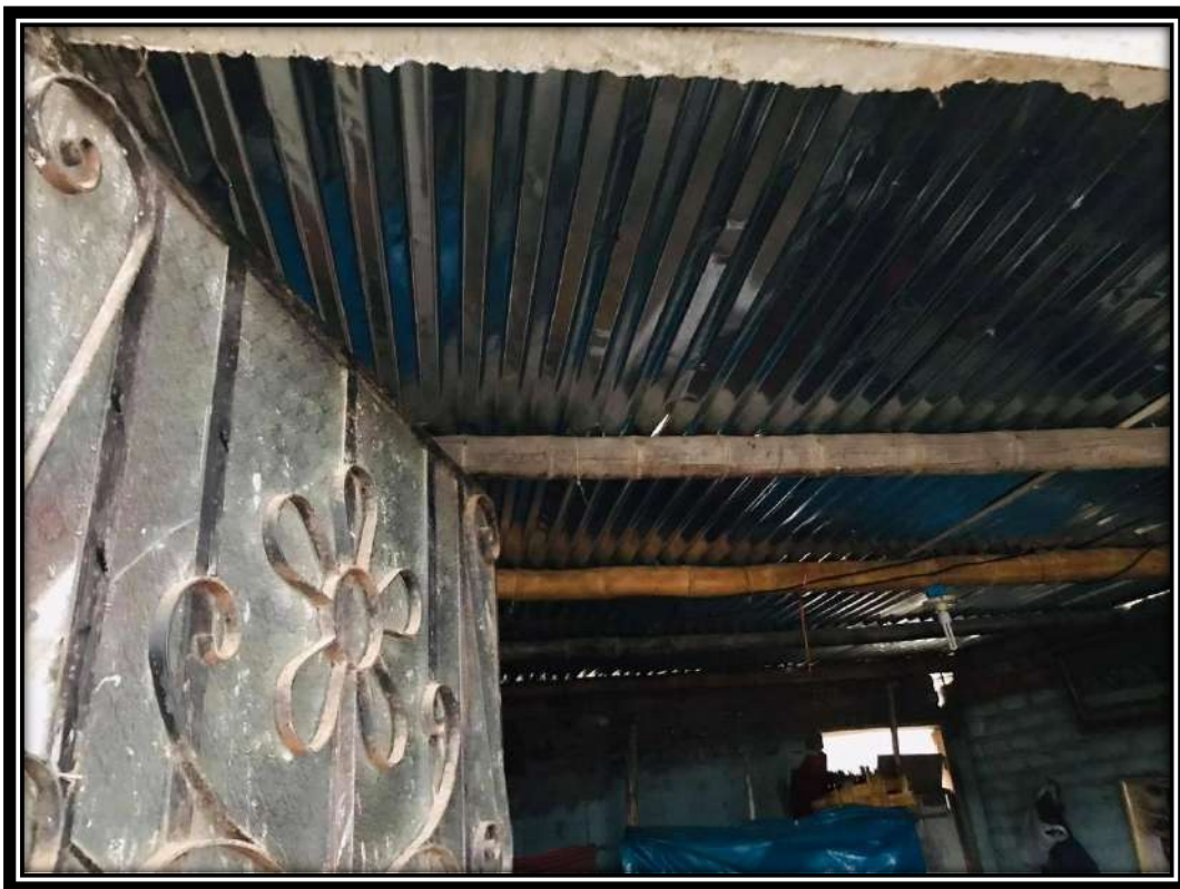
Figura 42: vivienda sin losa.
