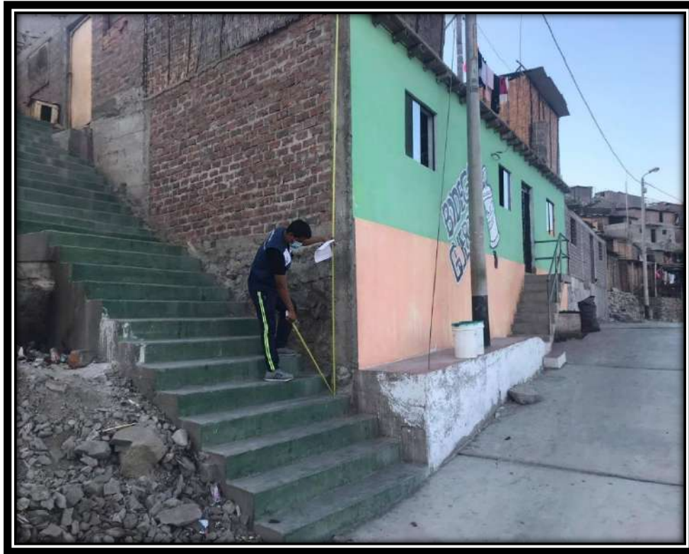
Figura 45: viviendas construidas sin vigas.
