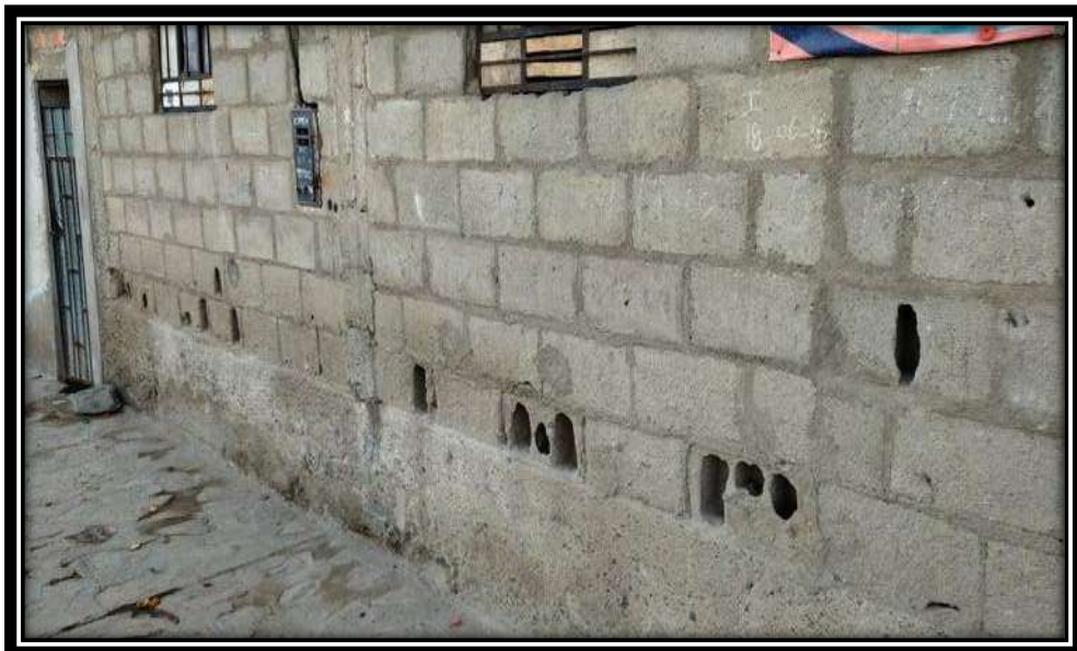
Figura 50: Vivienda en pésimo estado de conservación.
