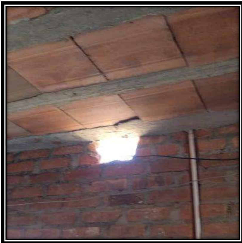
Figura 48: Debilitación de la viga.
