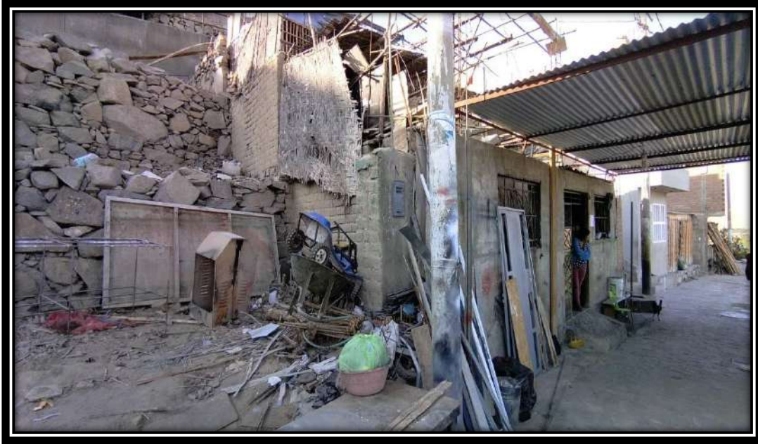
Figura 51: Vivienda en pésimo estado de conservación.
