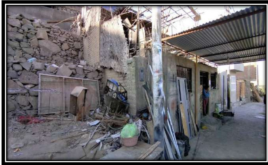
Figura 29 y 30: Viviendas en pésimo estado de conservación.
