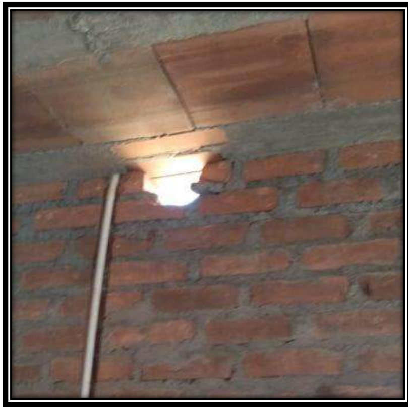
Figura 47: Ruptura de viga.
