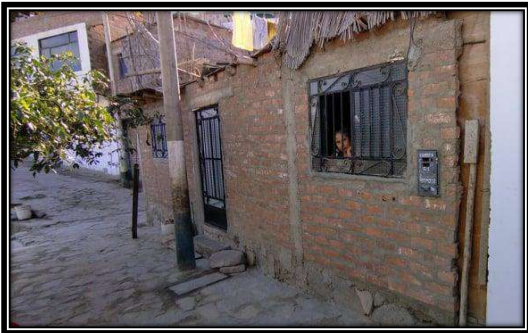
Figura 40: fachada de vivienda con vigas cortas.
