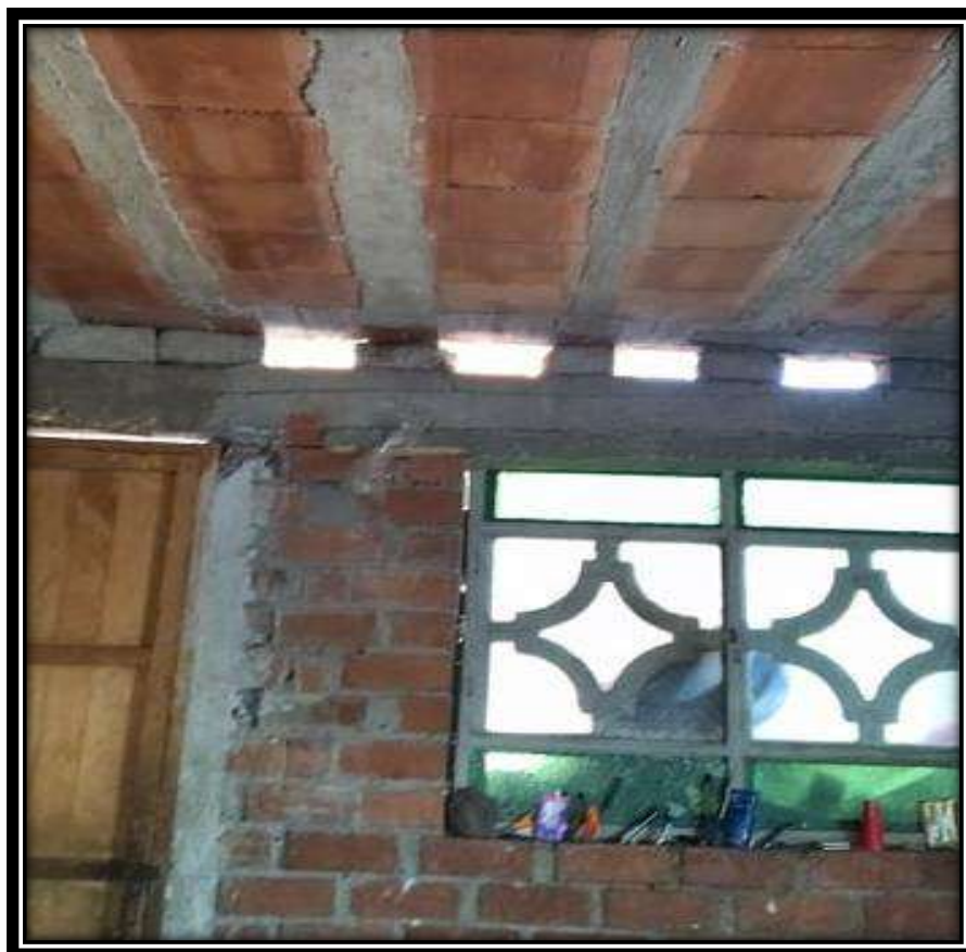
Figura 46: vivienda con orificios entre la losa y la viga.
