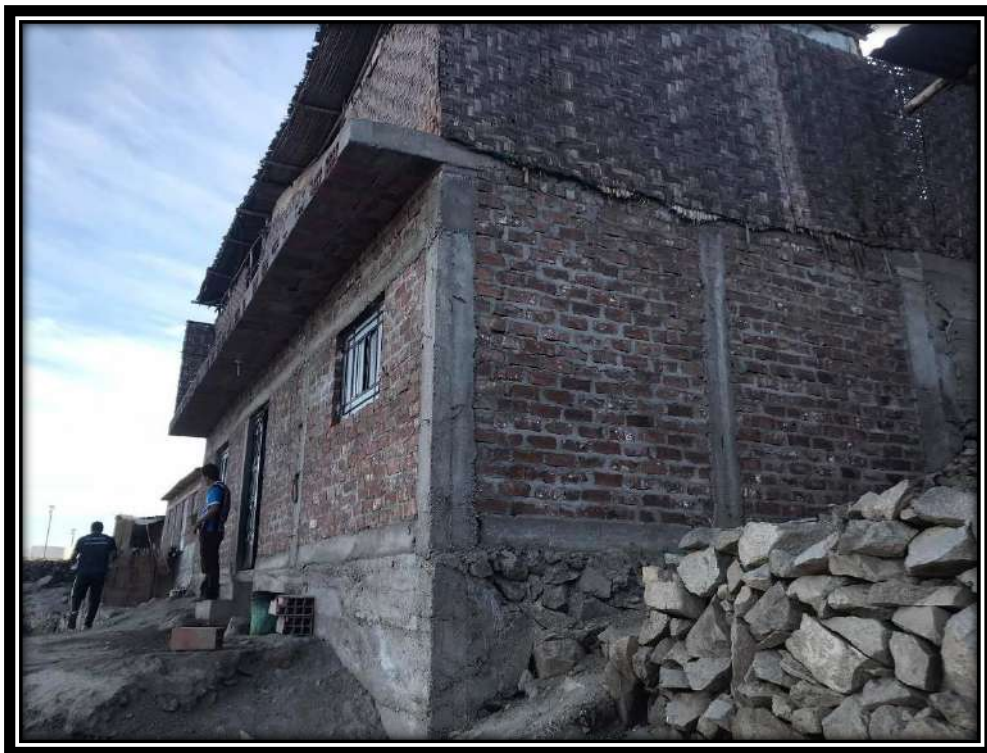
Figura 44: muros con salitre.
