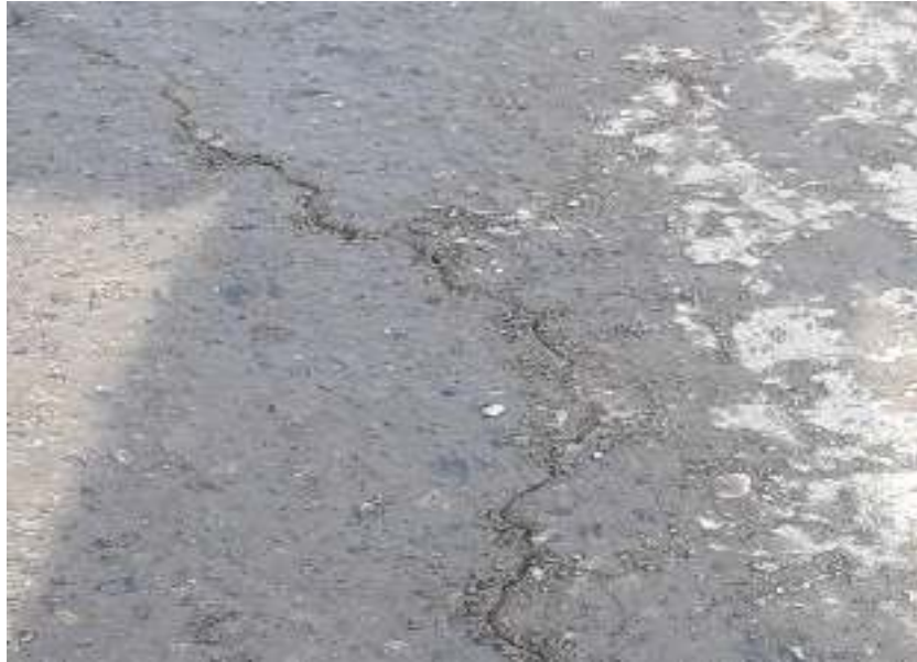
Figura 29: Calle. Jorge Chávez tramo 1 , Grietas longitudinales Fuente: Elaboración Propia
