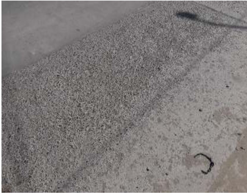
Figura 34: Calle. Jorge Chávez tramo 3, Pulimento de Agregados Fuente: Elaboración Propia
