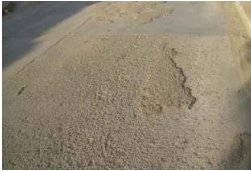
Figura 32: Calle. Jorge Chávez tramo 2 , pulimento de agregados Fuente: Elaboración Propia
