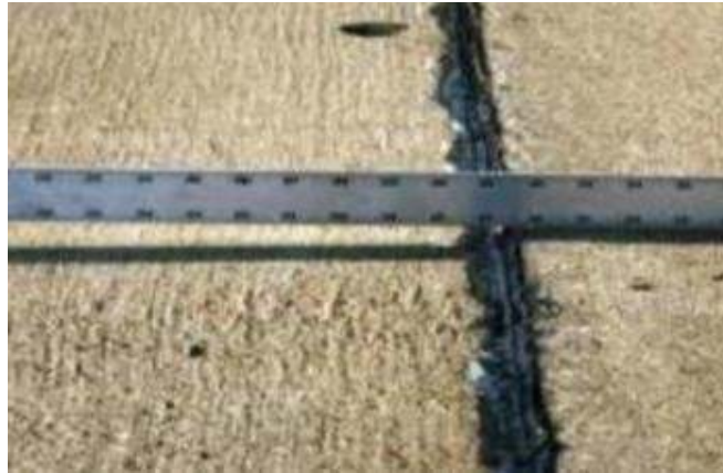
Figura N° 22: Escalonamiento entre Losas Adyacentes
