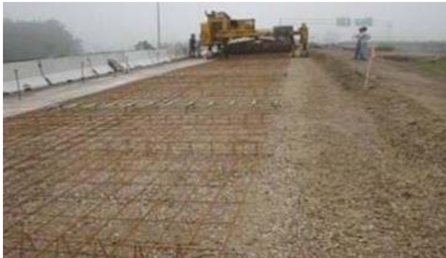
Figura N a 07: proceso constructivo de un pavimento de hormigón armado con acero y juntas.
