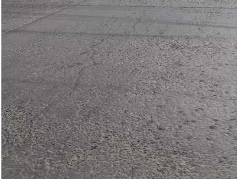
Figura 31: Calle. Jorge Chávez tramo 2 , Grietas Longitudinales y Popouts Fuente: Elaboración Propia
