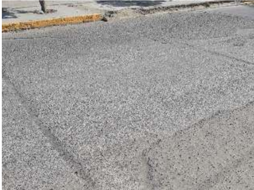
Figura 28: Calle. Jorge Chávez tramo 1 , Pulimiento de Agregados y Parche Fuente: Elaboración Propia
