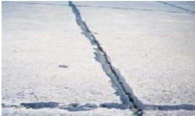
Figura N° 23: Perdida del Sello en las Juntas
