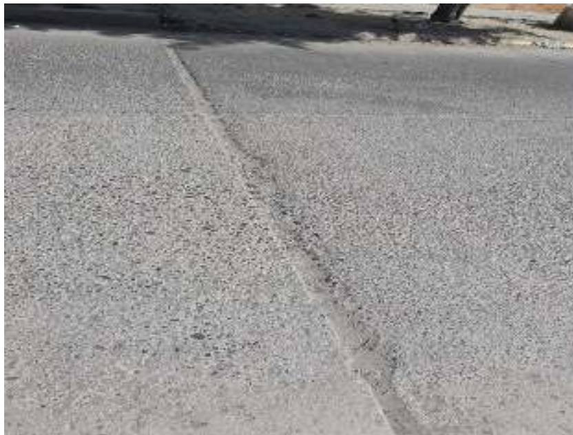
Figura 30: Calle. Jorge Chávez tramo 1 , Junta de sello de daños Fuente: Elaboración Propia
