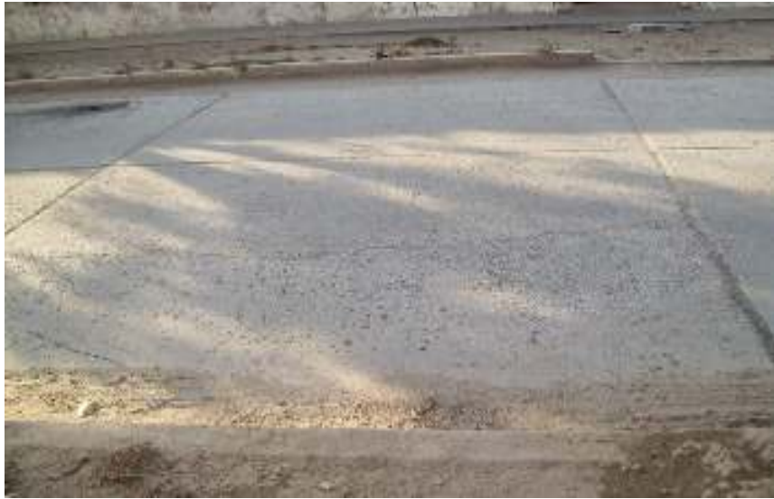
Figura 36: Calle. Jorge Chávez tramo 3, Grietas Longitudinales Fuente: Elaboración Propia
