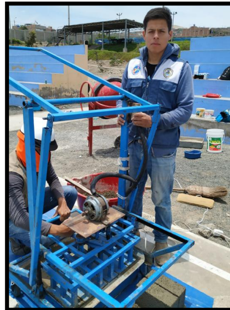
Figura 42. Después de quitar el exceso de material se procede a la segunda vibración y luego el desmolde de los ladrillos.
