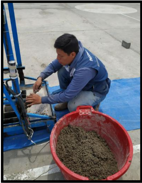
Figura 39. Colocamos la mezcla en un balde para posteriormente colocarla en la máquina de ladrillos.
