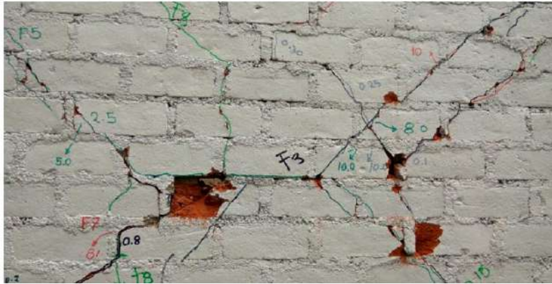
Figura 72.- Desplazamiento lateral de unidades en la mitad del muro.
