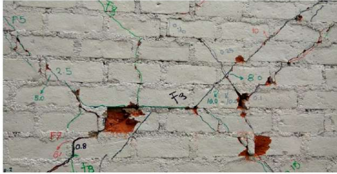
Figura 20.- Desplazamiento lateral de unidades en la mitad del muro.
