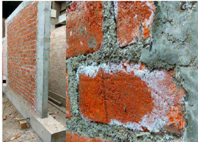
Figura 63.- Salinidad en el muro de albañilería, hechos con ladrillos artesanales de la zona de Chiupampa-Huaraz
