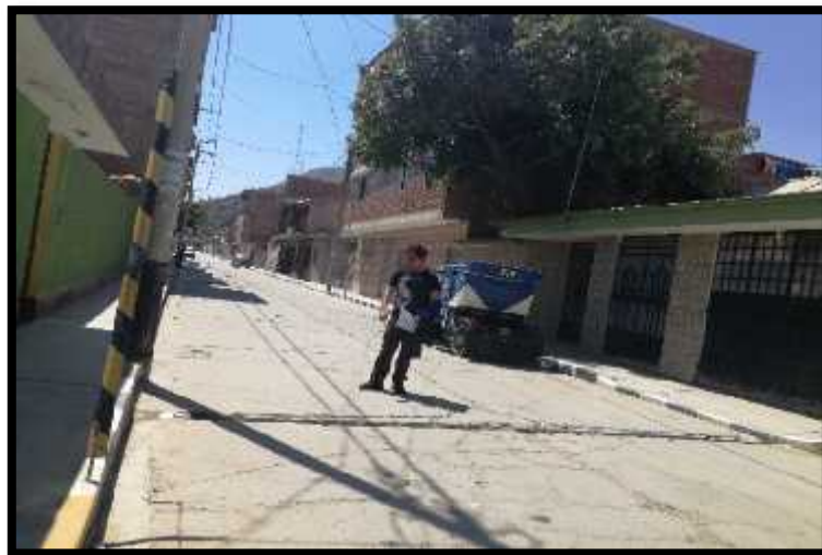
FIGURA 06: SE PUEDE APRECIAR LA SEVERIDAD DE FISURACION FUENTE: EL AUTOR
