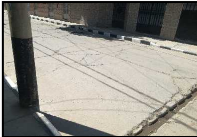
FIGURA 20: VISTA DEL TIPO DE FALLA LOSA DIVIDIDA Y GRIETA LINEAL RESPECTIVA EN JR.MIGUEL GRAU FUENTE: EL AUTOR
