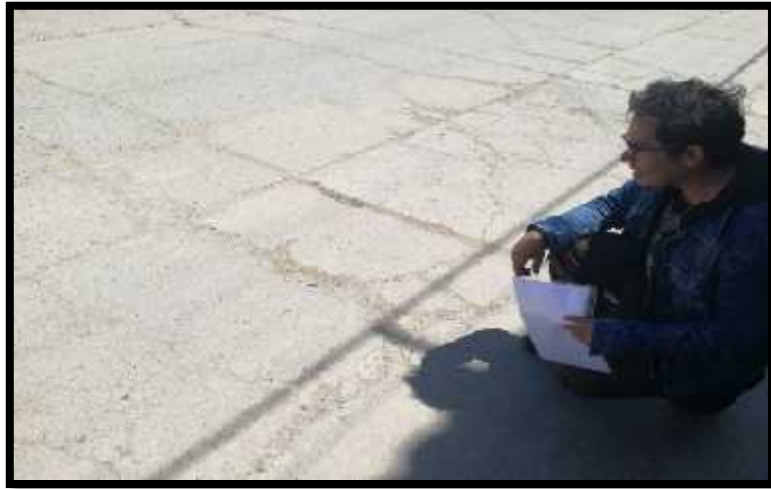
FIGURA 05: SE PUEDE APRECIAR LA SEVERIDAD DE LOSA DIVIDIDA FUENTE: EL AUTOR
