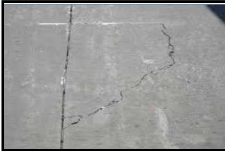
FIGURA 07: GRIETAS LINEALES FUENTE: JAVIER M (2010)- Deterioro en pavimentos rígidos y flexibles
