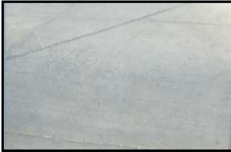
FIGURA 09: PULIMIENTO DE AGREGADOS FUENTE: JAVIER M (2010)- Deterioro en pavimentos rígidos y flexibles
