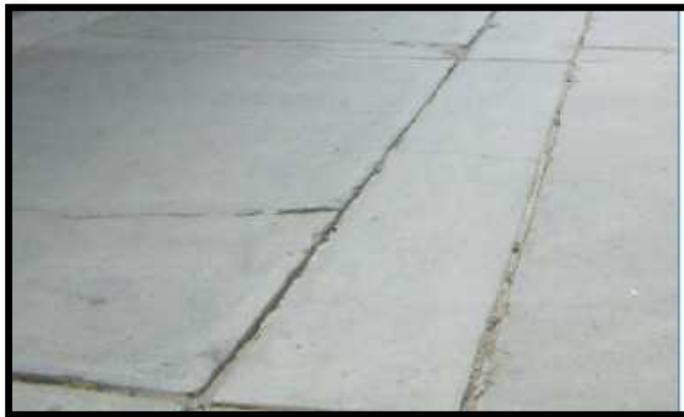
FIGURA 10: PARCHEGRANDE FUENTE: JAVIER M (2010)- Deterioro en pavimentos rígidos y flexibles
