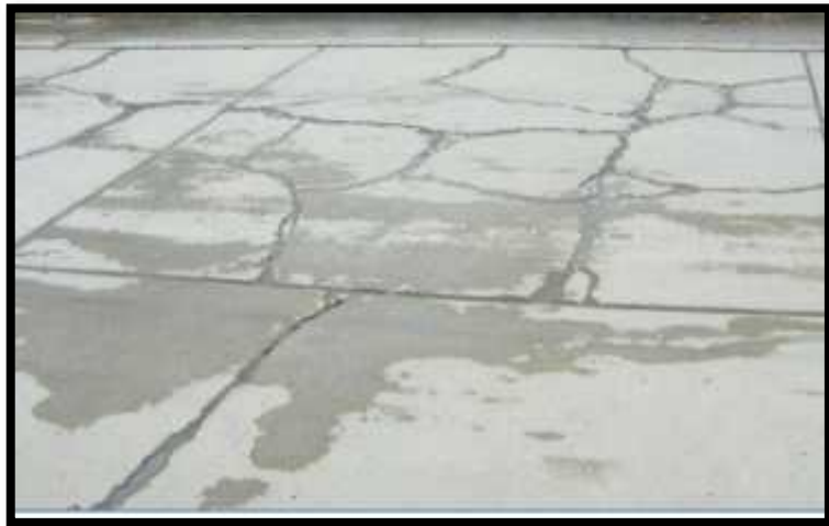
FIGURA 08: LOSA DIVIDIDA FUENTE: JAVIER M (2010)- Deterioro en pavimentos rígidos y flexibles
