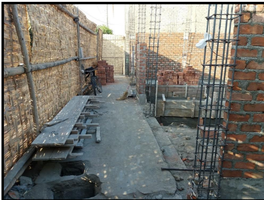
Figura 29: Falta de señalización al ingreso del área de trabajo Fuente. Fotografía, Jesus Mendoza.
