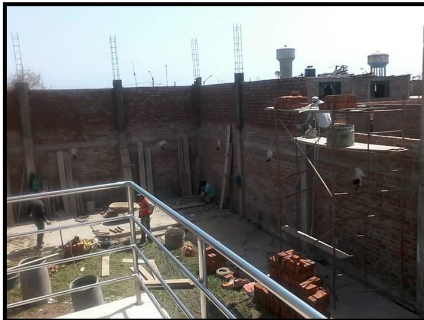
Figura 32: Trabajos en altura sin arnés de seguridad. Fuente. Fotografía, Grover Gamboa.
