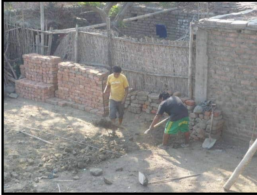
Figura 31: Excavación manual de zanja sin EPP Fuente. Fotografía, Grover Gamboa.
