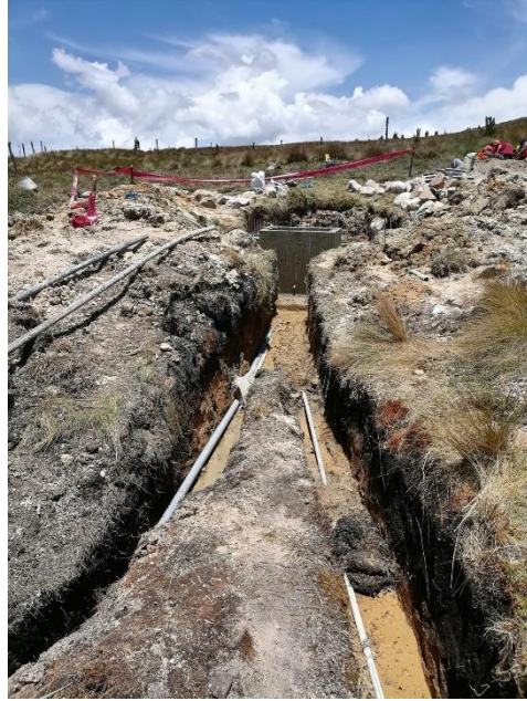
Figura 07: Tuberías para redes de distribución sector Progreso la Toma (actualmente en mantenimiento – estado de riesgo)
