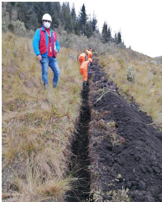
Figura 08: Zanja para tuberías de redes de distribución sector Tuyupampa (actualmente en mantenimiento– estado de riesgo)
