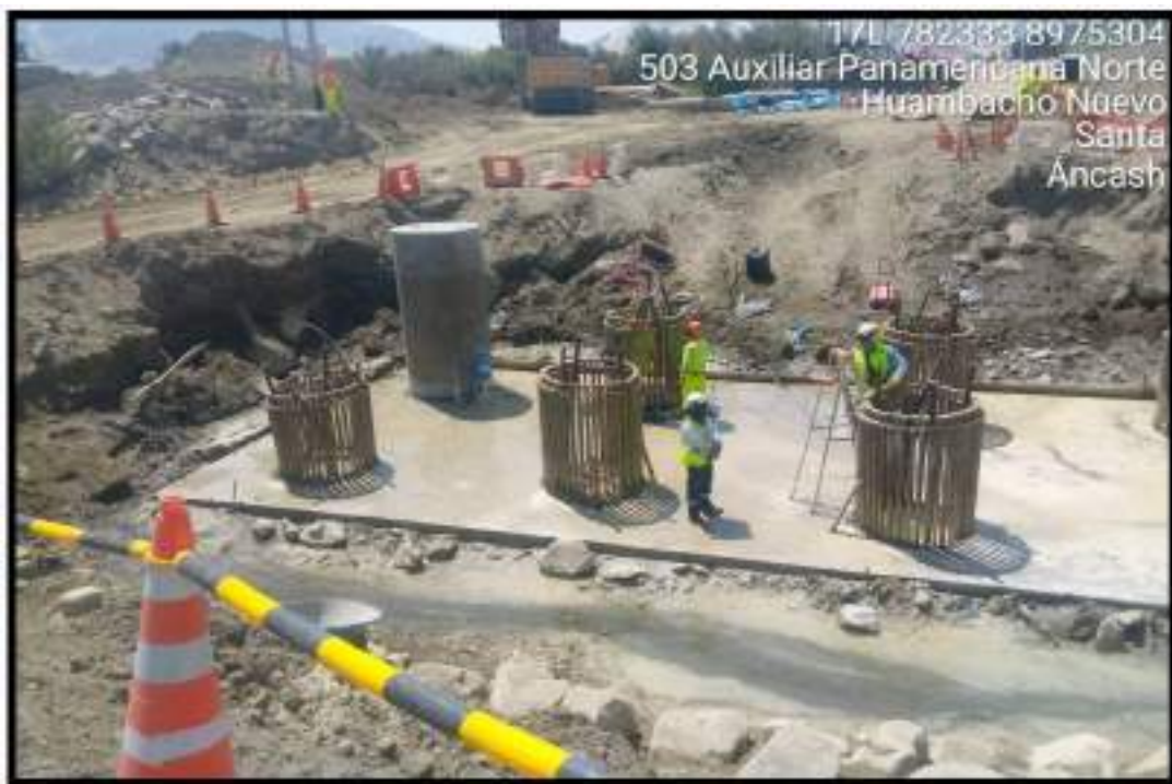
Fotografía N°06: Pilotes descabezados y fuste (concreto f'c=280 \text{ kg/cm}^2 ) del pilote preparado para realizar la prueba de carga dinámica.
