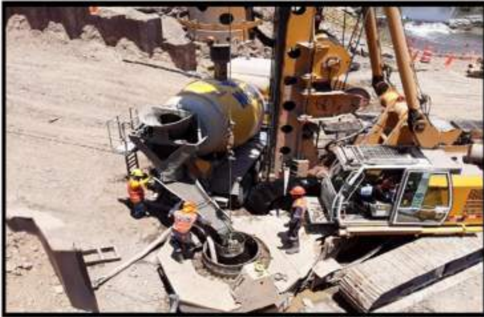
Fotografía N°03: Vaciado de concreto premezclado f'c=280 kg/cm 2 con la tubería tremie. Proveedor: UNICON.
