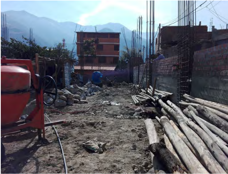
Figura 4. Escombros de la edificación
