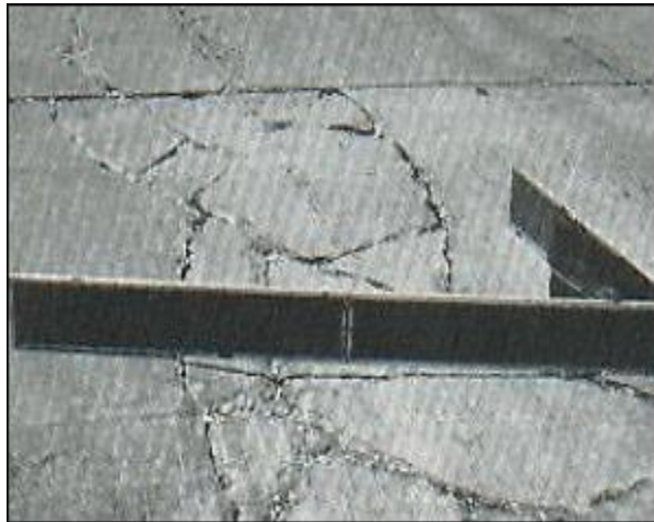
Figure N°19. Punzamiento de alta severidad
