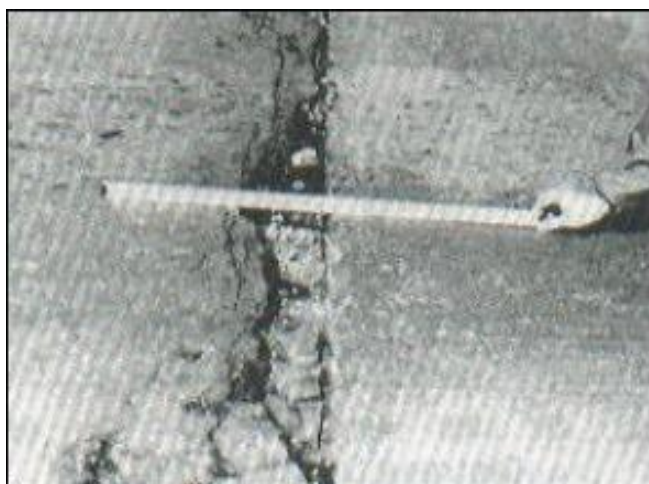
Figura N°23. Descascaramiento de junta
