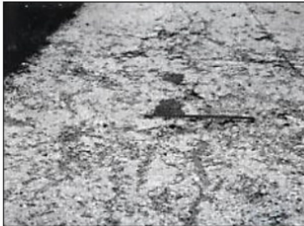
Figura N°21. Agrietamiento tipo mapeo, Descaramiento de alta severidad.
