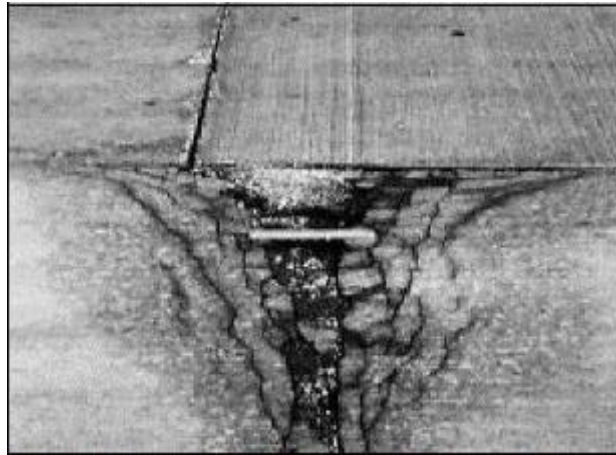
Figura N°9. Grietas de durabilidad de mediana severidad.
