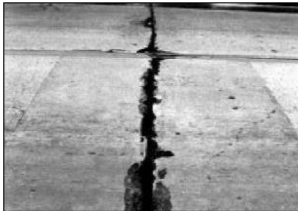
Figura N°11. Deterioro del sello de la junta mediana severidad.
