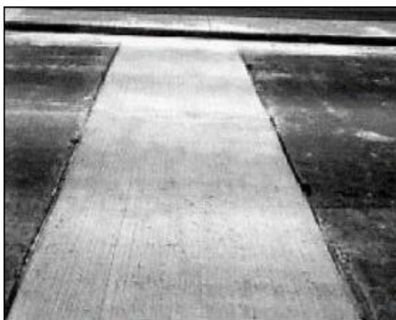
Figura N°14. Parcheo mediano de mediana severidad.
