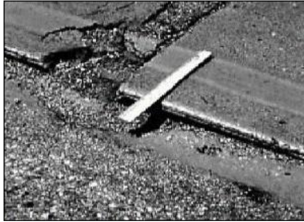
Figura N°12.Desnivel carril / berma de baja severidad.
