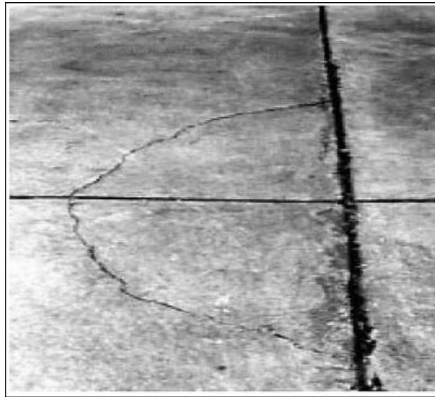
Figura N° 7. Grietas en esquina de baja severidad.
