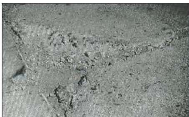
Figura N°22. Descascaramiento de esquina de alta severidad.
