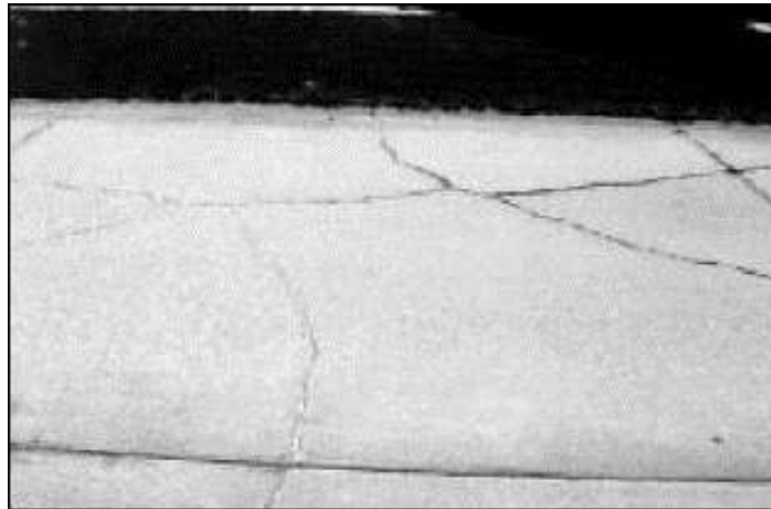
Figura N°8. Losas dividida de mediana severidad.
