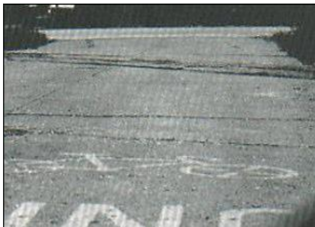
Figure N°20. Cruce de vía férrea de severidad media.
