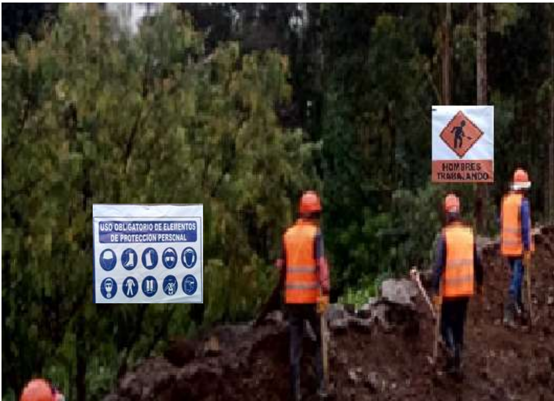
Figura 25 Trabajador alertados sobre la necesidad de señales preventivas a fin de estar siempre alertas y con el equipo de protección personal
