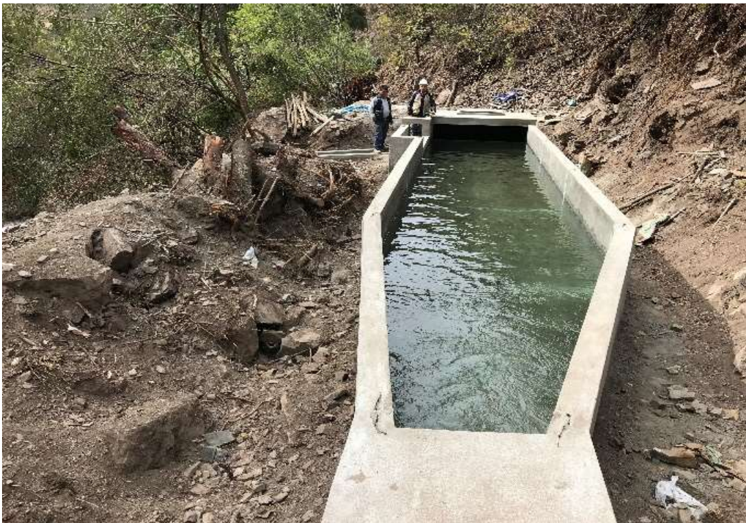
Figura 18. Se observa el desarenador.
