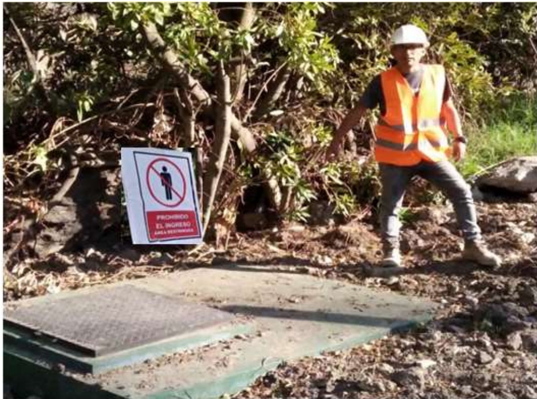
Figura 22. Señales preventivas alertando a los trabajadores que hay una obra inconclusa
