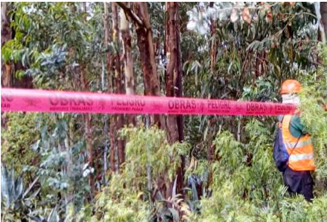
Figura 24 Trabajo realizado en espacios difíciles con la seguridad necesaria, garantizando la integridad física del trabajador
