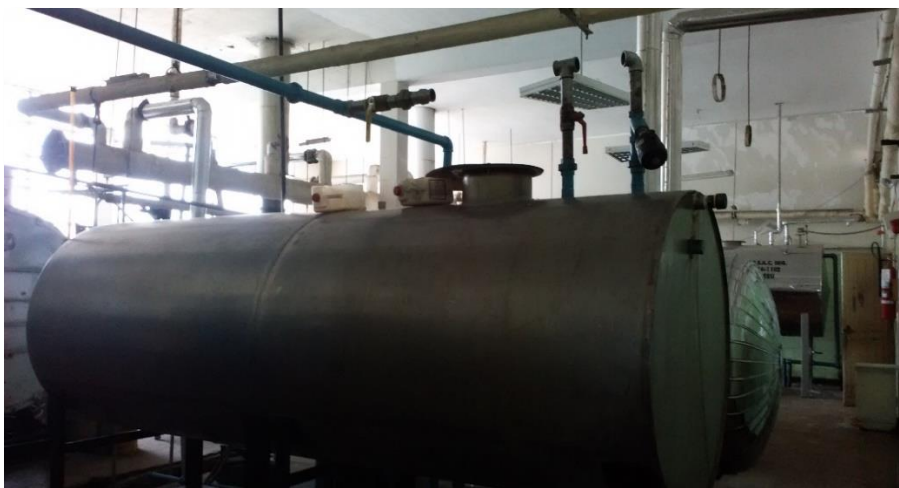
Figura 3 Calentador de agua a vapor del Hospital III ESSALUD, 2019
