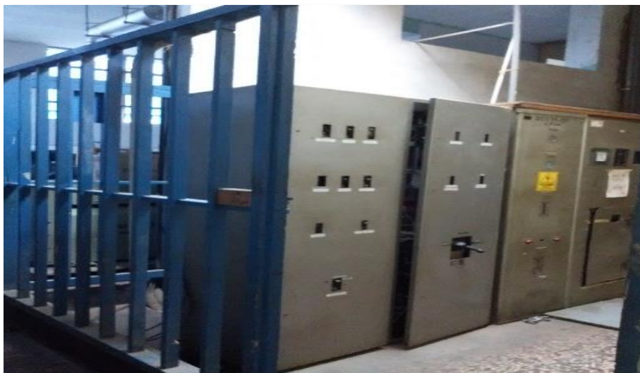
Figura 4 Tableros de distribución del Hospital III ESSALUD, 2019
