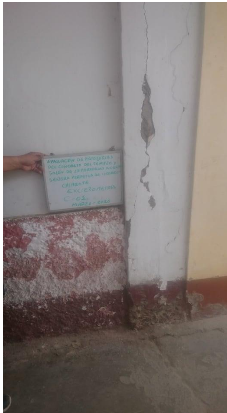
Figura N°19. Área afectada de la columna
