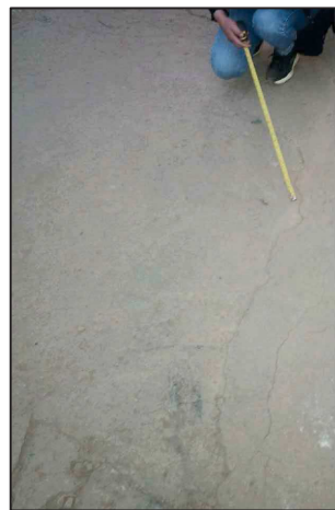
F02 GRIETAS LINEALES
