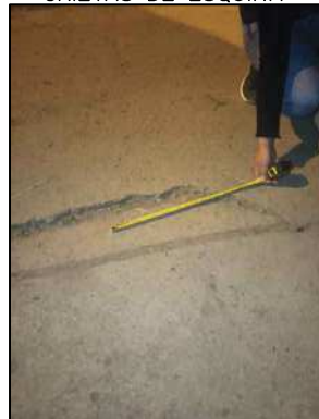
F03 GRIETAS DE ESQUINA
