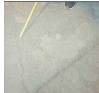
F04 GRIETAS LINEALES
