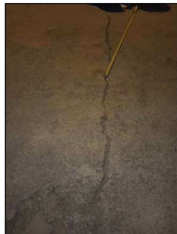
F03 GRIETA LINEAL
