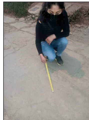
F04 GRIETAS LINEALES
