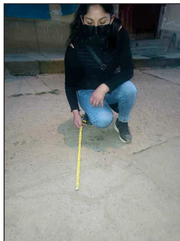
F03 GRIETAS DE ESQUINA
