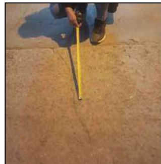
F02 GRIETAS LINEALES
