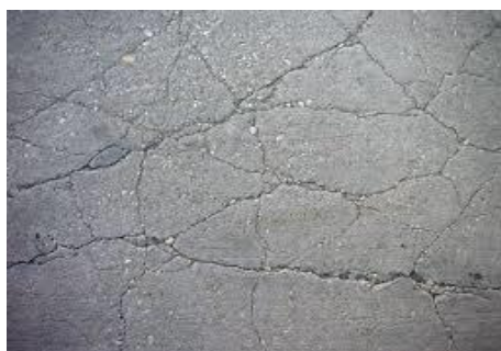
Figura 19. Fisuración por retracción o tipo malla
