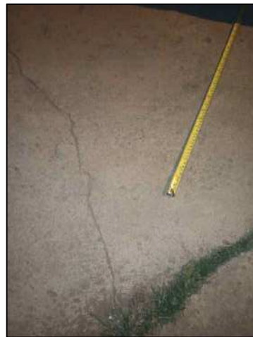
F02 GRIETA LINEAL
