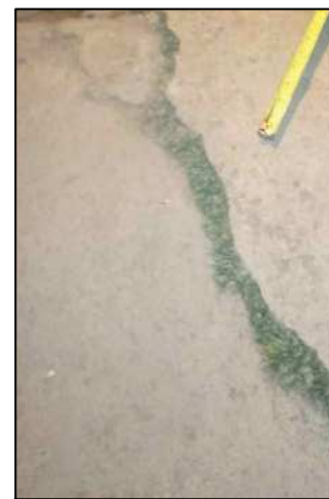
F04 GRIETA LINEAL
