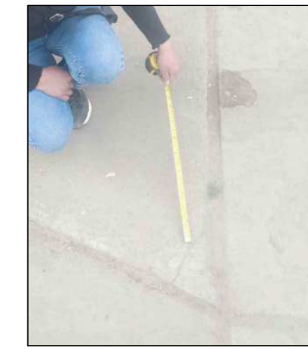
F01 GRIETAS DE ESQUINA
