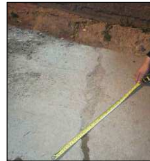
F04 GRIETAS LINEALES
