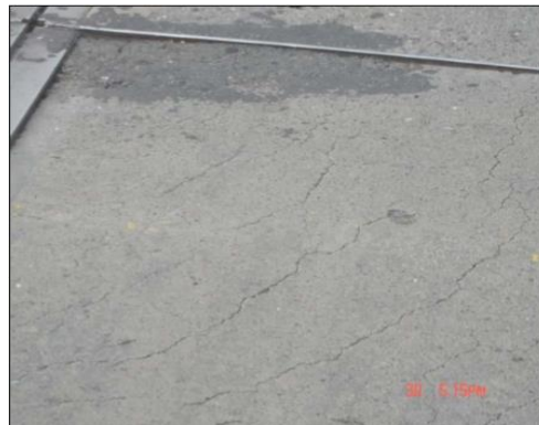
Figura 20. Fisuraciones ligeras de aparición temprana
