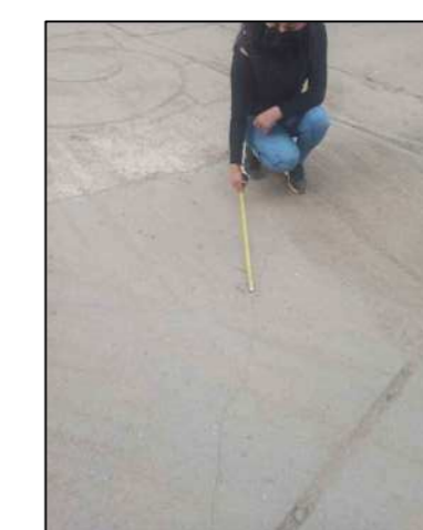
F05 GRIETAS LINEALES
