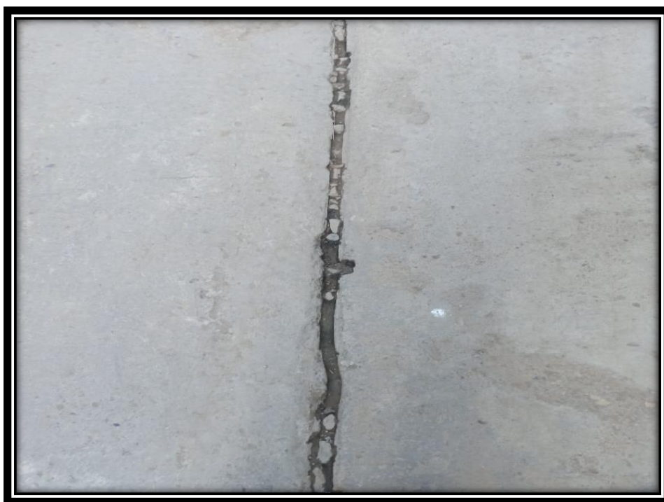
Anexo N° 19 Deterioro del sello
