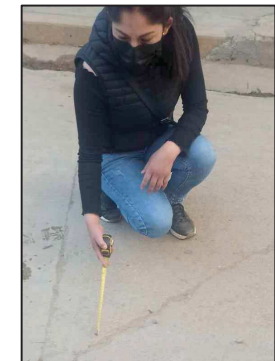
F04 GRIETAS LINEALES
