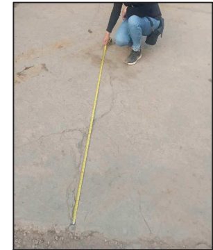
F02 GRIETAS LINEALES
