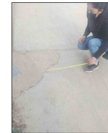
F03 GRIETAS DE ESQUINA
