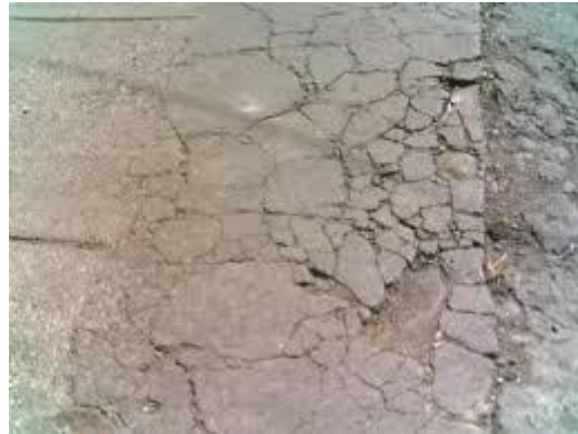
Figura 11. Grietas en bloques
