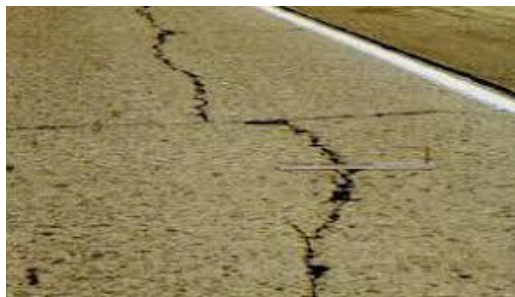
Figura 10. Grietas en los pasadores
