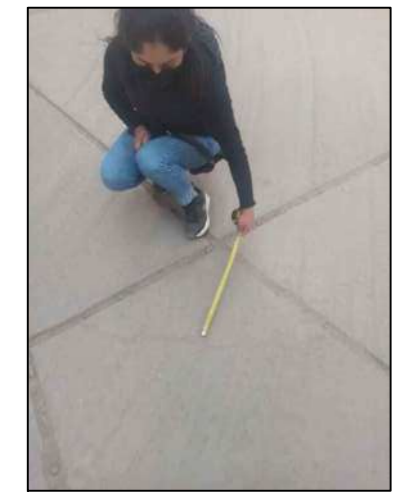
F04 GRIETAS DE ESQUINA
