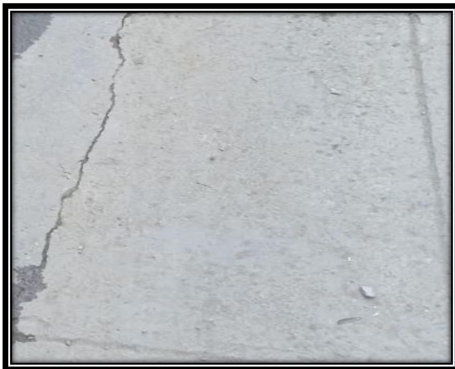
Anexo N° 18 Grieta lineal
