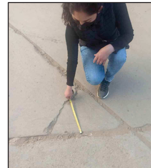
F03 GRIETAS DE ESQUINA
