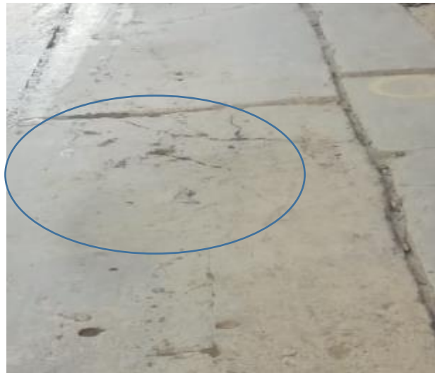
Figura 7. Grieta de esquina
