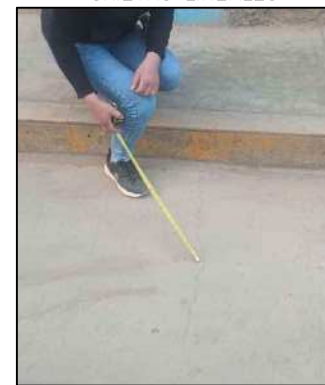
F04 GRIETAS LINEALES
