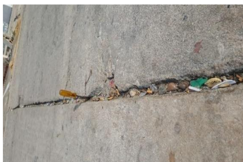
Figura 13. Deterioro de sello
