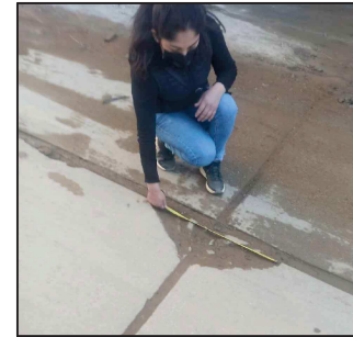
F01 GRIETAS DE ESQUINA
