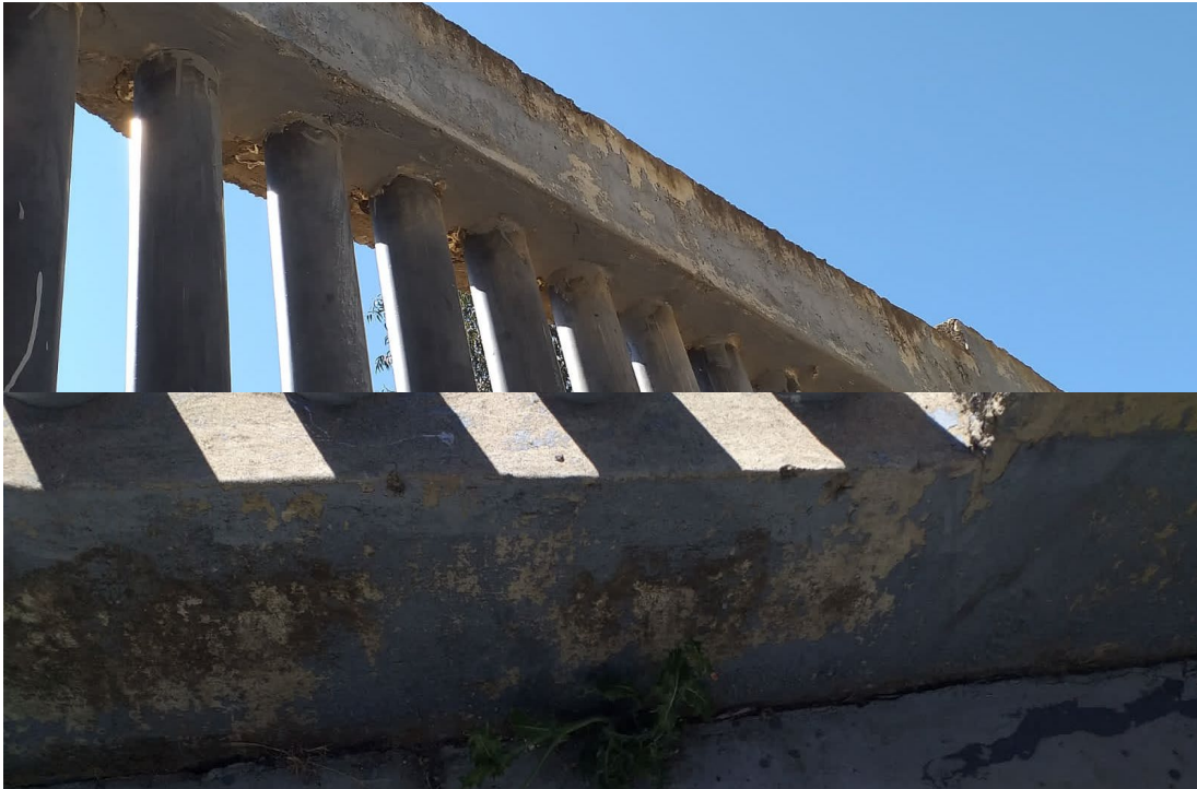
Figura N° 24: Presencia de florescencia en cerco perimétrico
