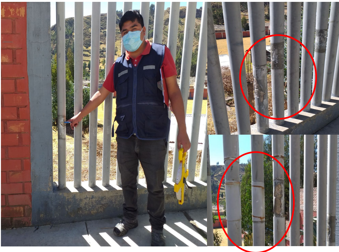
Figura N° 29: Presencia de erosión en el concreto del cerco perimétrico
