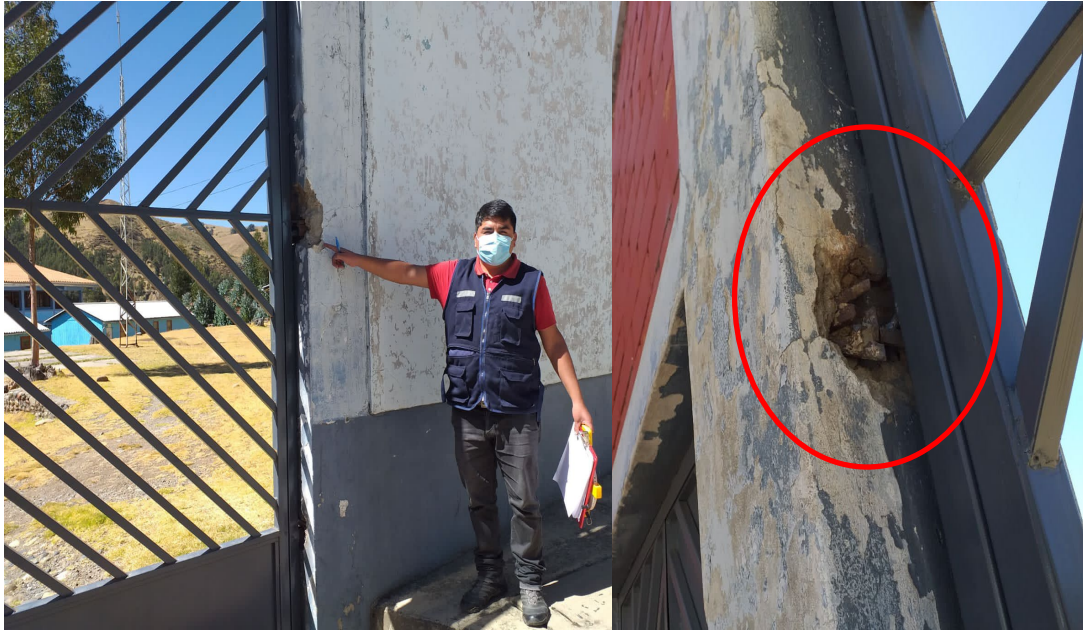
Figura N° 28: Presencia de corrosión en el acero del cerco perimétrico
