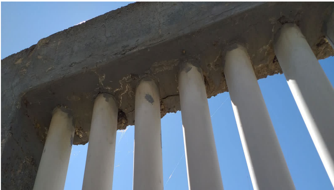
Figura N° 25: Presencia de erosión en cerco perimétrico
