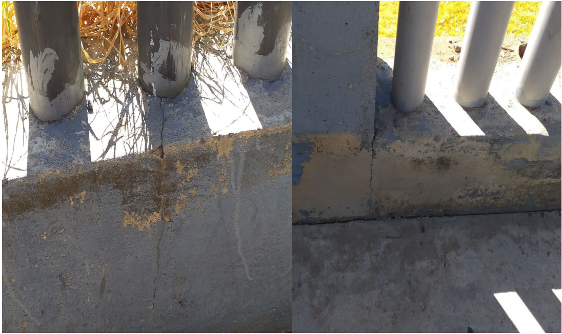
Figura N° 26: Presencia de fisuras en cerco perimétrico
