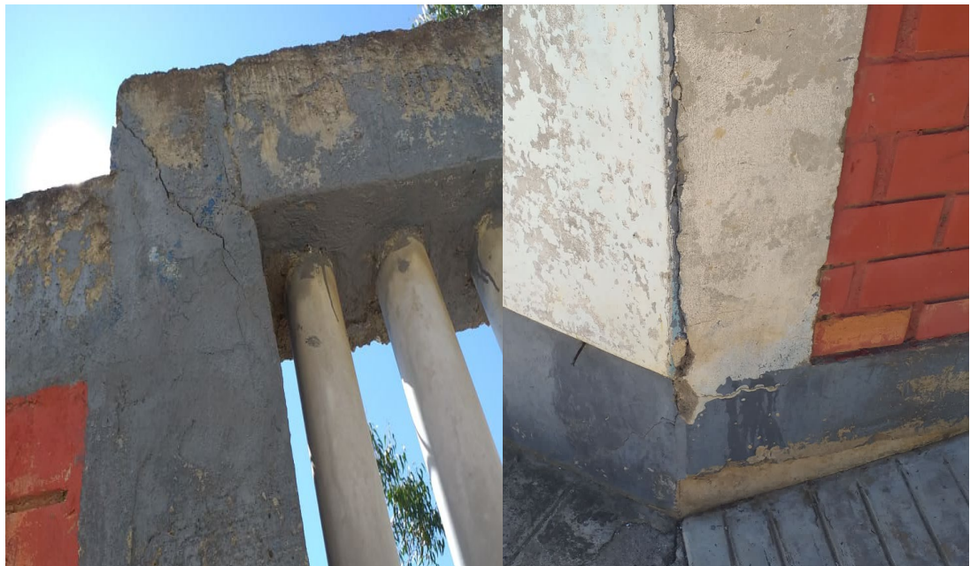
Figura N° 27: Presencia de grietas en cerco perimétrico
