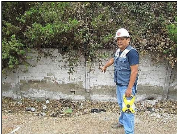
Fig. 78: TRAMO DETERIORADO DE CERCO PERIMETRICO EXTERIOR - FRENTE PANAMERICANA NORTE
