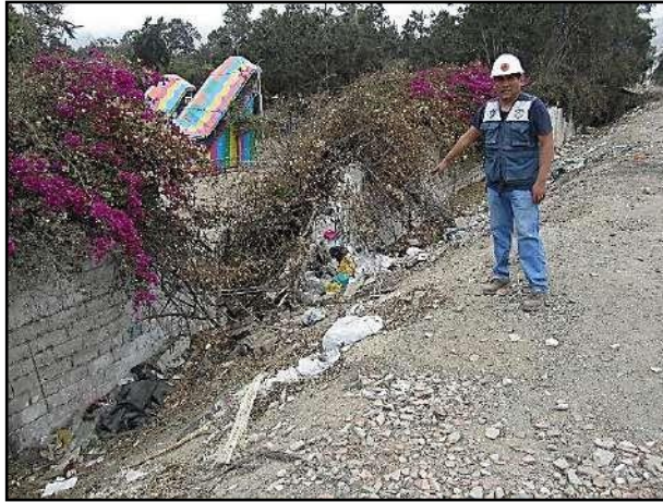
Fig. 77: TRAMO DERRIBADO DE CERCO PERIMETRICO EXTERIOR - FRENTE PANAMERICANA NORTE
