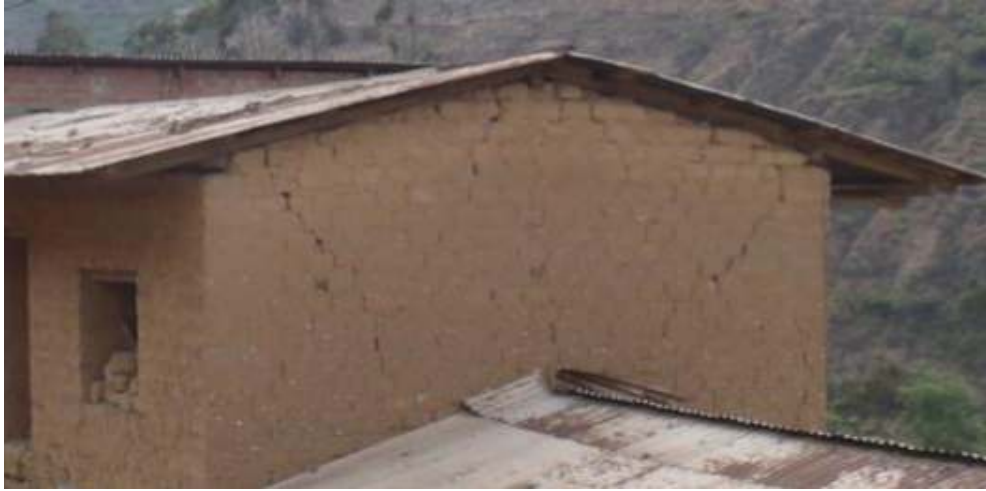
Figura 47. Falla por corte.
