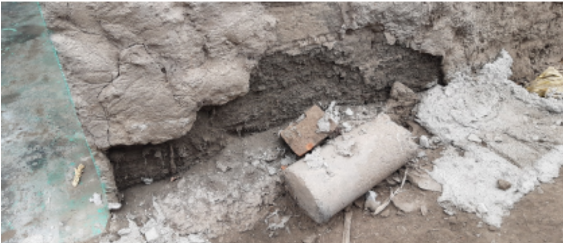
Figura 72: Muro solaqueado con mortero de cemento debido al deterioro.
