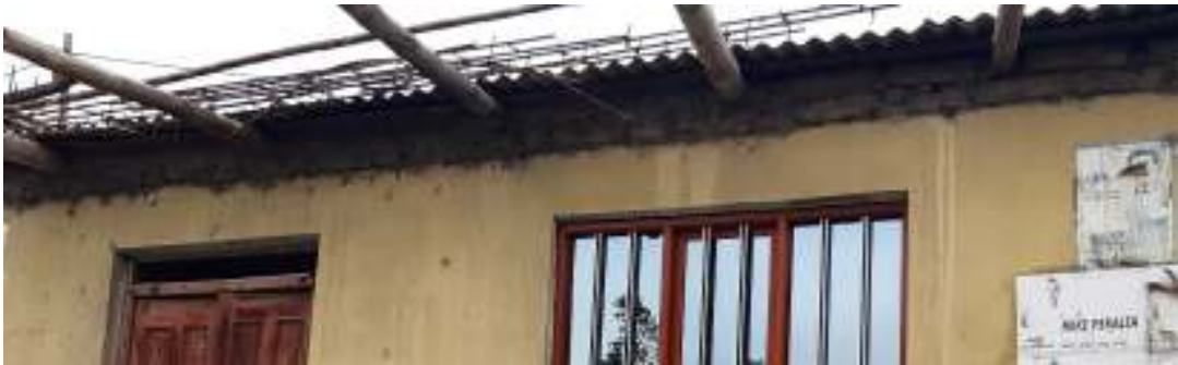
Figura 61: Vivienda con cubierta de eternith con viguetas de palo de Guayaquil de 6" sin arriostre horizontal.
