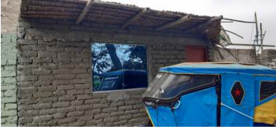
Figura 62: Vivienda con cubierta de esteras y cañas con viguetas de Guayaquil sin arriostre.
