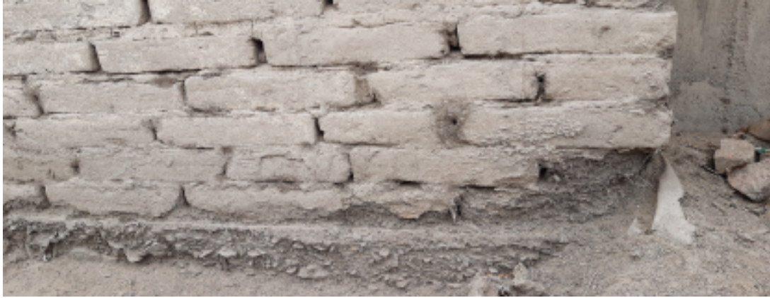
Figura 71: Sobrecimiento de concreto ciclópeo con deterioro.
