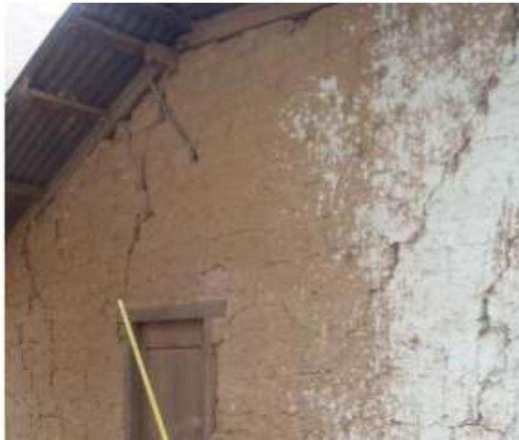
Figura 48: Grietas cerca de los vanos.
