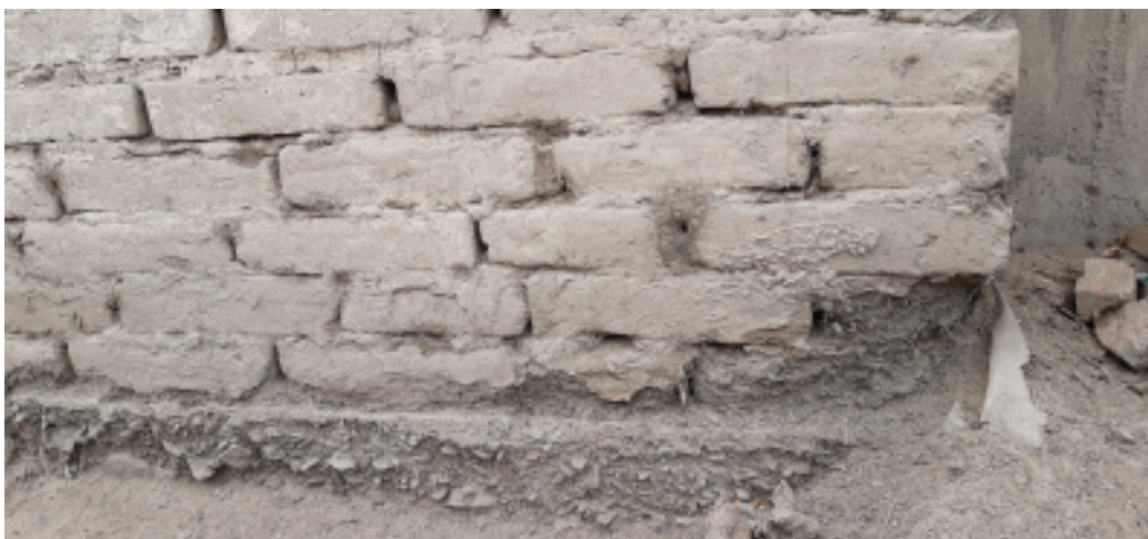
Figura 64: Vivienda con adobes presentando salitre y deterioro.
