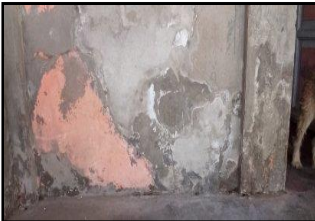
Foto 9: Muros de albañilería expuesto a la humedad, vulnerabilidad alta.
