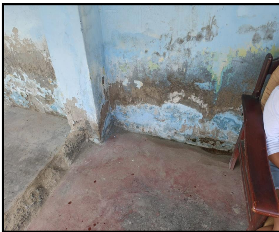
Foto 2: Muros con presencia de fluorescencia y grietas. Vulnerabilidad Media.
