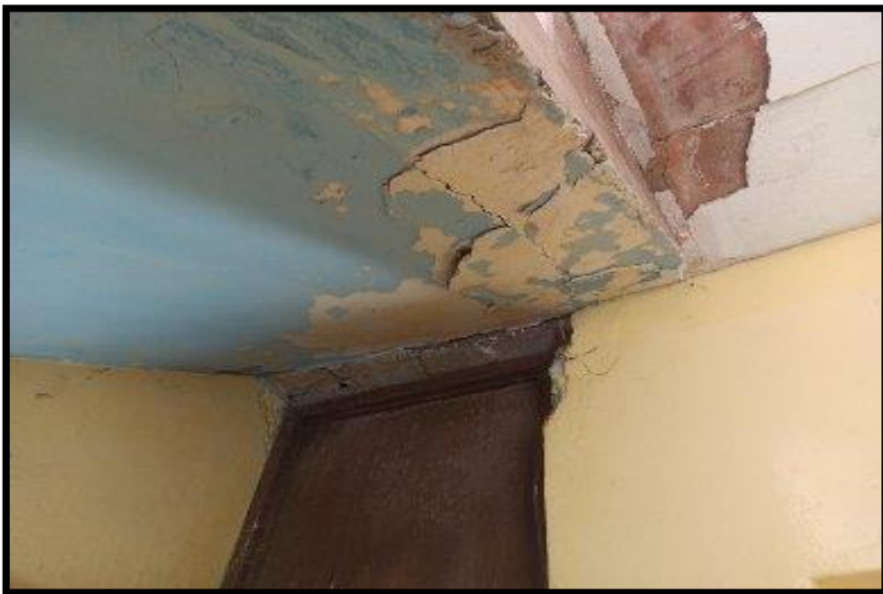
Foto 4: deteriorada por el salitre y fluorescencia, vulnerabilidad alta.
