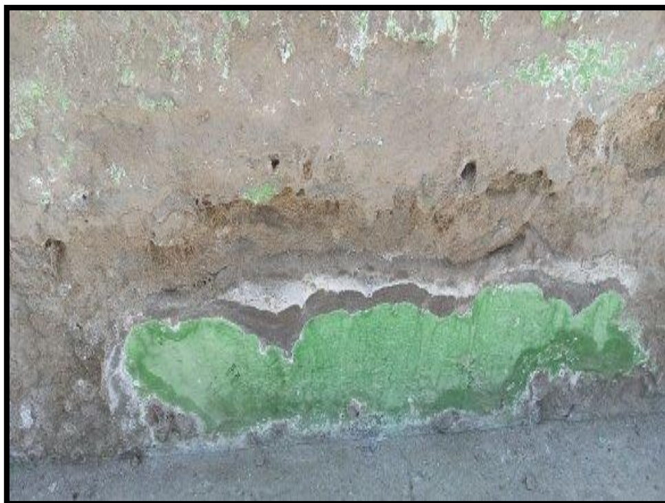
Foto 5: Muro deteriorado por el salitre, vulnerabilidad alta.
