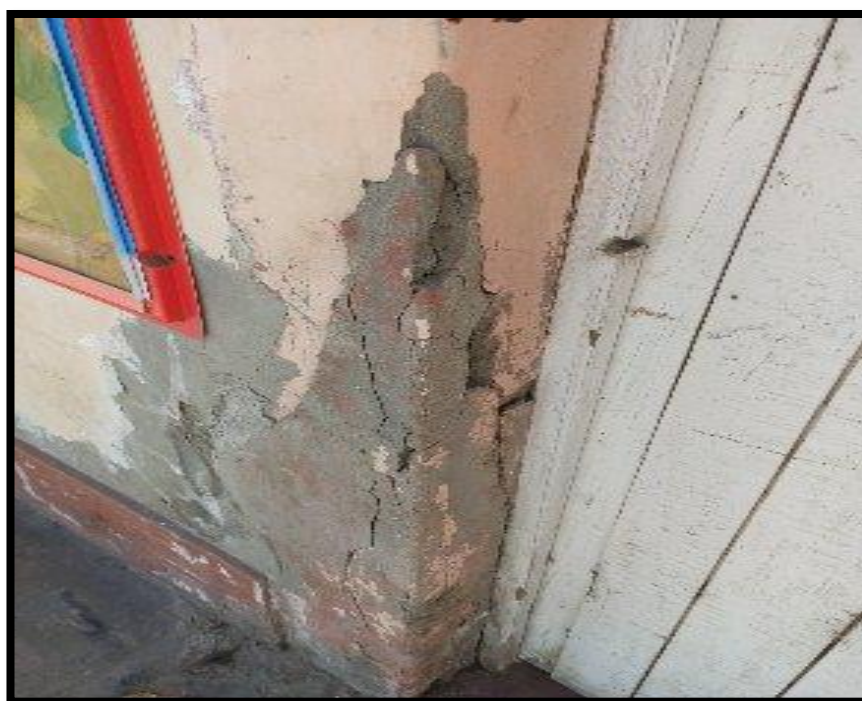
Foto 12: Columnas en mal estado, con presencia de salitre y acero expuesto, vulnerabilidad alta.
