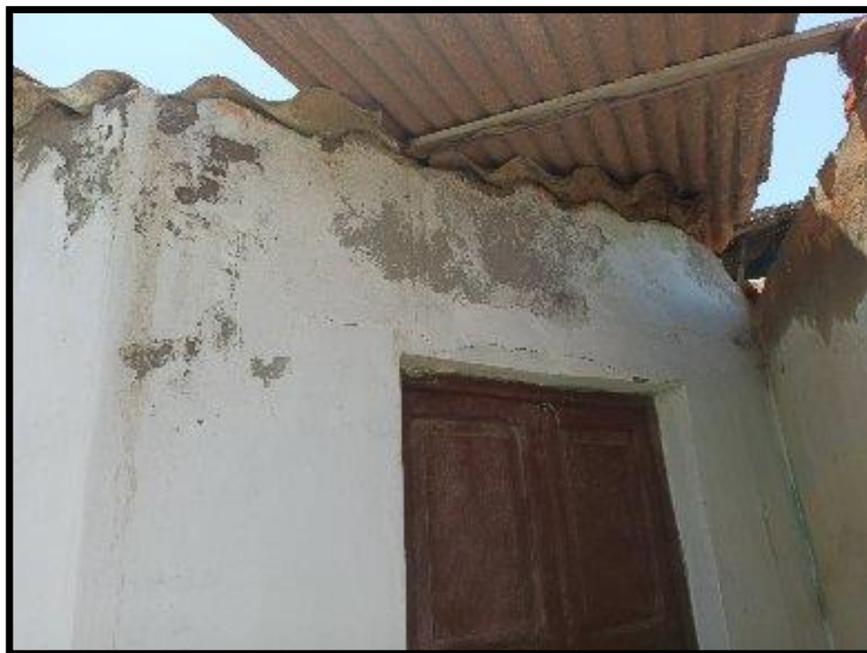
Foto 6: Muros sin confinamiento, en mal estado, vulnerabilidad alta.
