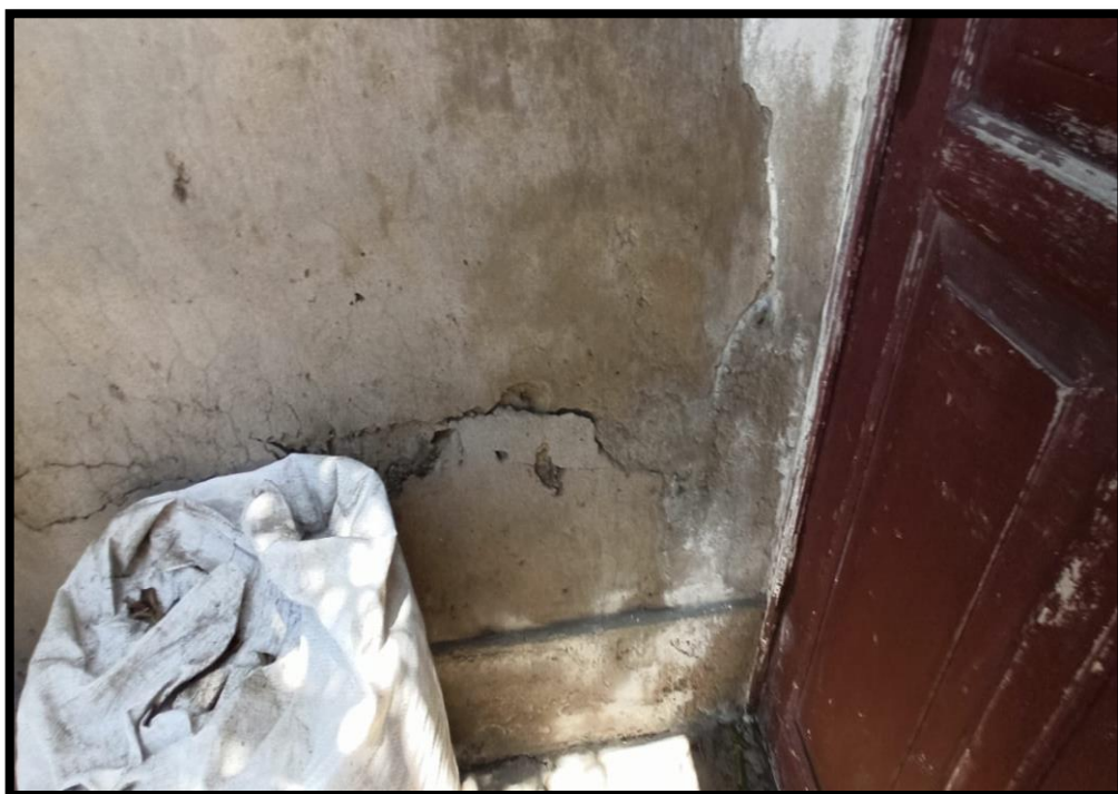
Foto 11: Muros de albañilería agrietados y con presencia de salitre, vulnerabilidad alta.
