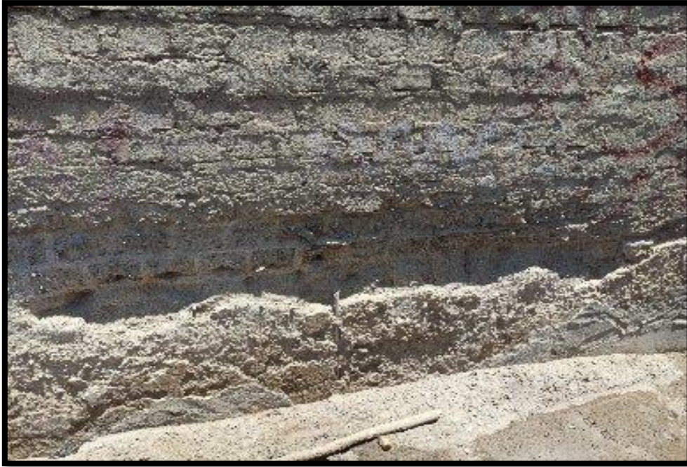
Foto 3: Muros en mal estado. Vulnerabilidad Alta
