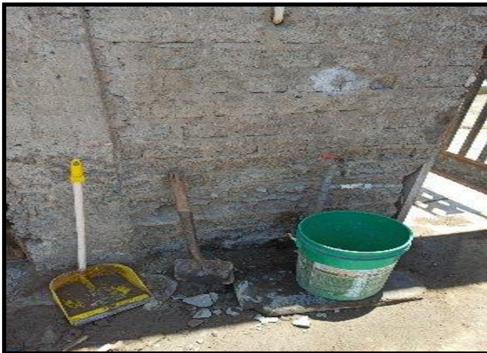
Foto 8: Muros confinados con presencia de salitre y fluorescencia, vulnerabilidad alta.
