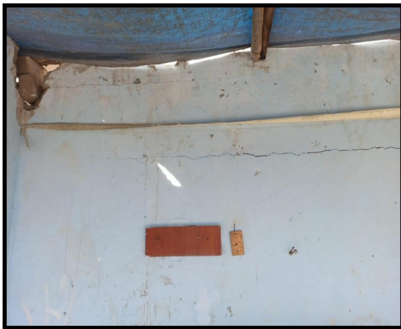
Foto 1: Muros con grietas. Vulnerabilidad alta.
