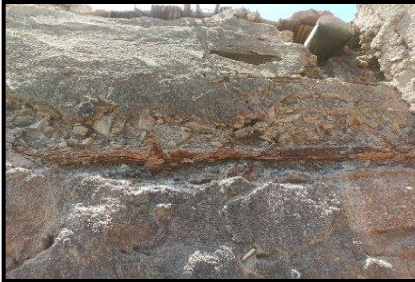
Foto 7: Acero expuesto por el salitre, vulnerabilidad alta.
