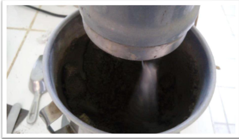
Foto N° 13: Una vez obtenida la mezcla de cemento y arena, se procede a ponerla en la mezcladora, durante 2 minutos. Luego de eso se echa el agua para que mezcle durante otros 2 minutos más.
