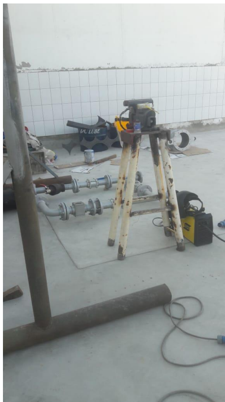
FIGURA 14. Instalaciones del taller F.D.S. E.I.R.L.
