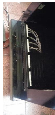
Figura 37. Colocación de los Patch Panel en el gabinete principal.
