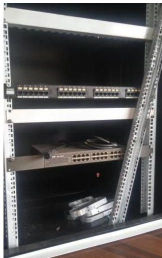
Figura 36 Ensamblando el Gabinete Principal.
