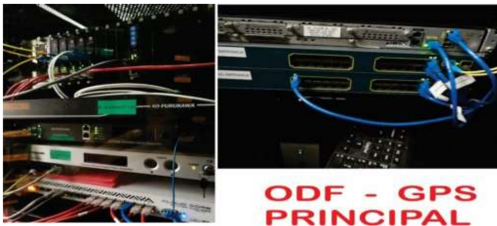
Figura 15: Rack de ubicación principal de ODF Del Jr. Gálvez.
