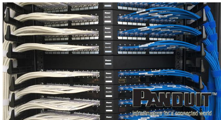
Figura N° 05. Administración de cables tipo PANDUIT
