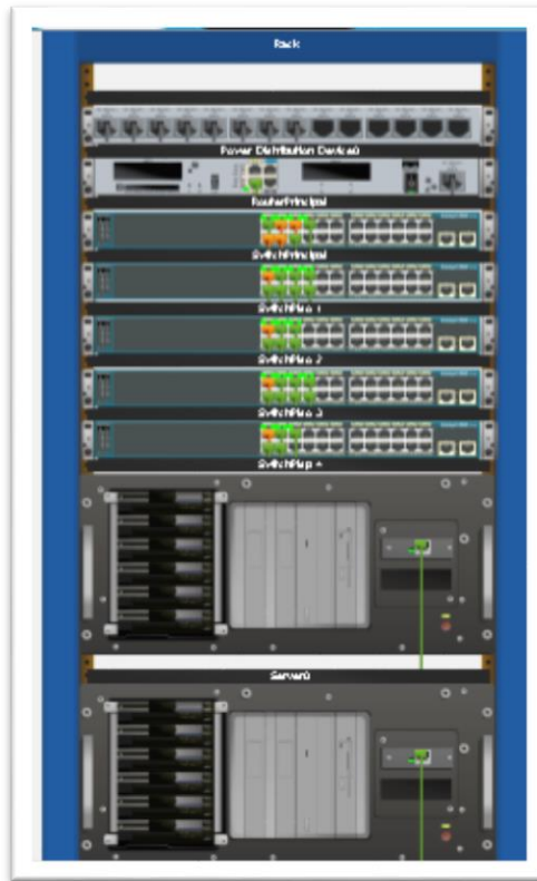
Figura N° 13. Gabinete de Telecomunicaciones Principal
