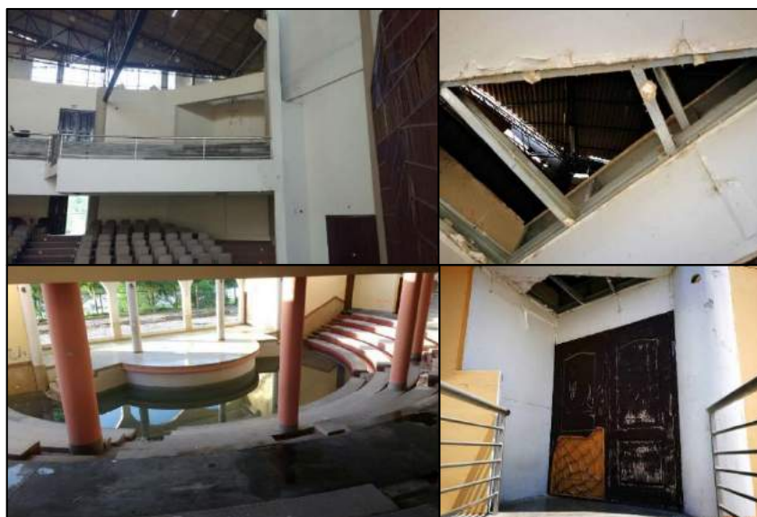
Figura 2. Estado del centro de convenciones en la provincia de Sullana Fuente: Propia.
